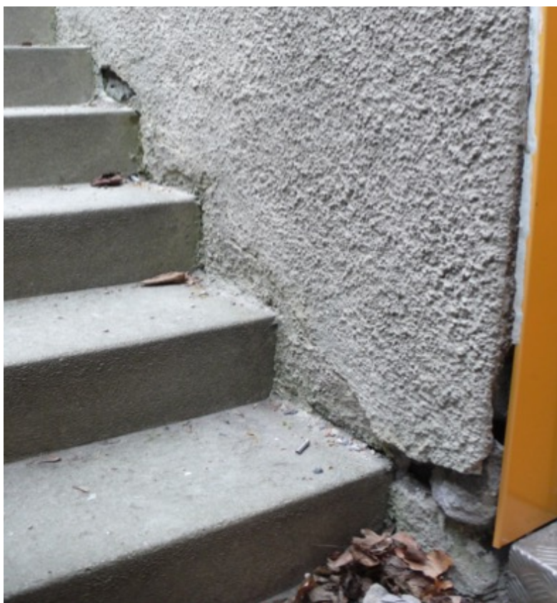
Bild 12. Skador i sockelputs i trappnedgång till källare till vänster om entré 16.
