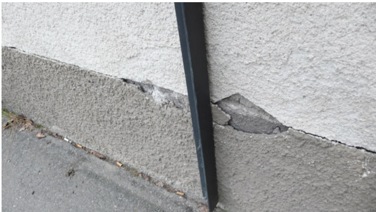
Bild 9. Större sprickor och hål i sockel samt puts-skador i anslutning till sockel med lös puts och öppna anslutningar.
