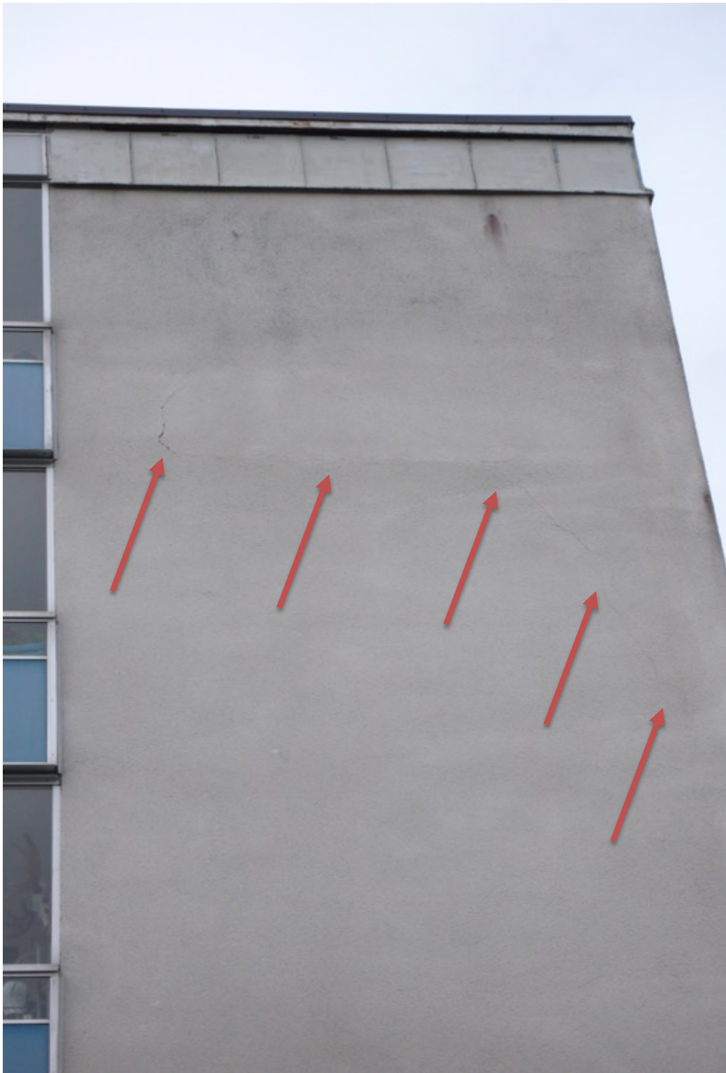
Bild 4. Lång spricka som kräver ytterligare undersökning med tanke på orsak och allvarlighetsgrad.
