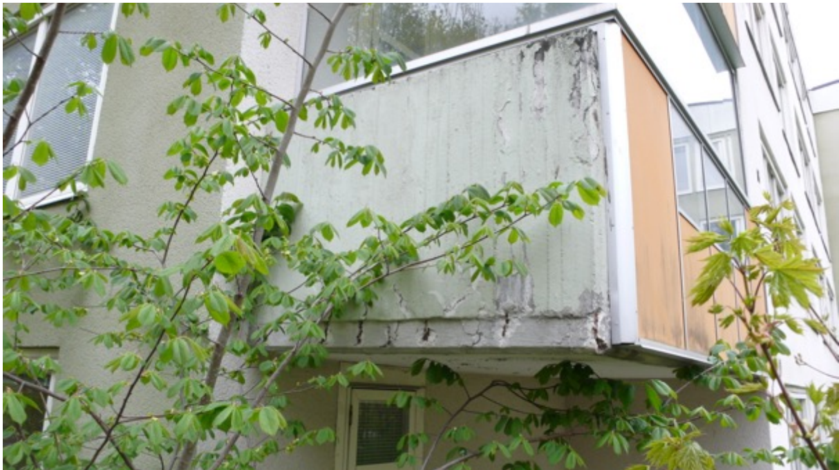
Bild 16. Buskar och träd tätt inpå fasad och balkongplatta vån 1. Skador på balkongplatta och balkongsida samt rostig armering.
