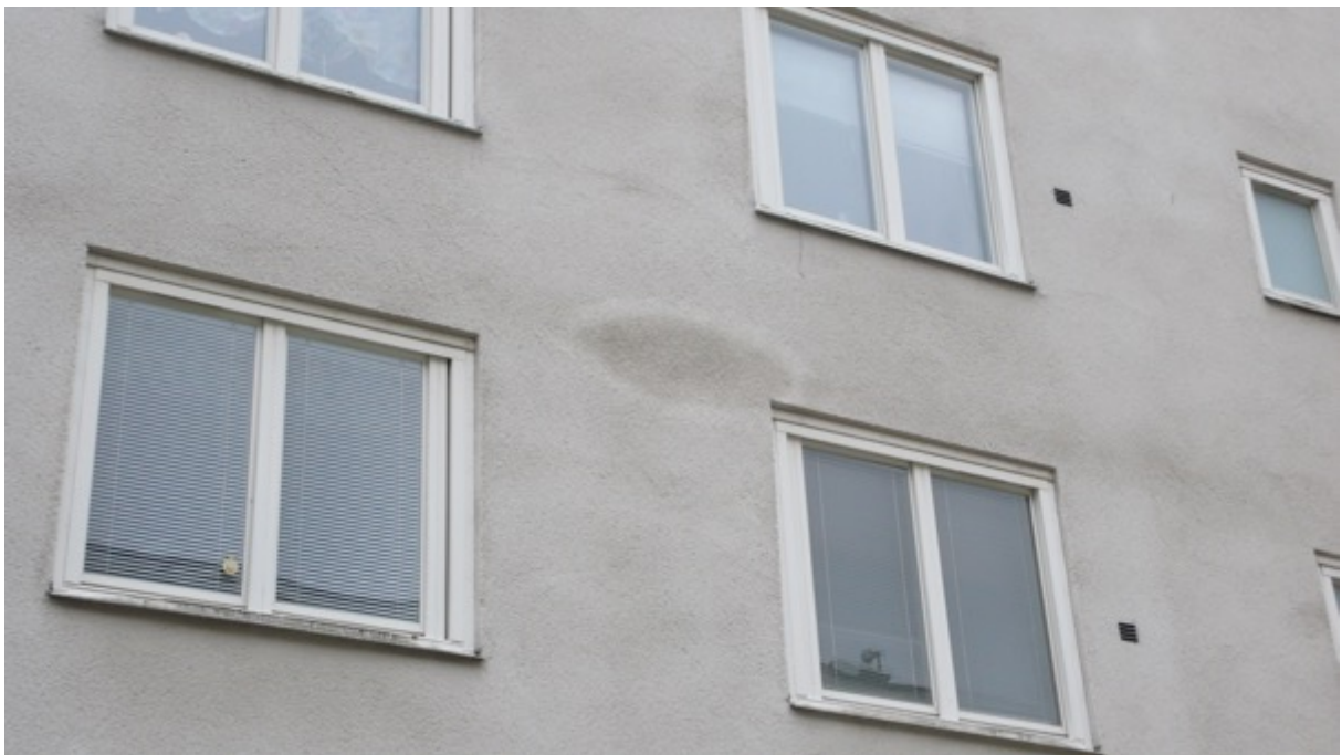
Bild 4. Fuktutslag ovan entré 10 fasad mot norr indikerar ett läckage inifrån.
