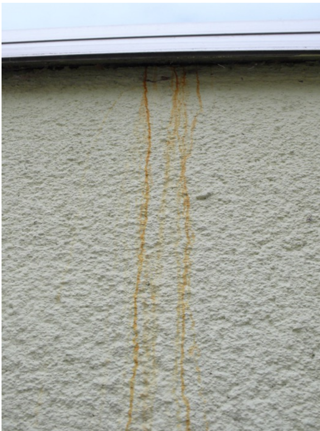
Bild 5. Rinningar på fasad under fönsterbleck.
