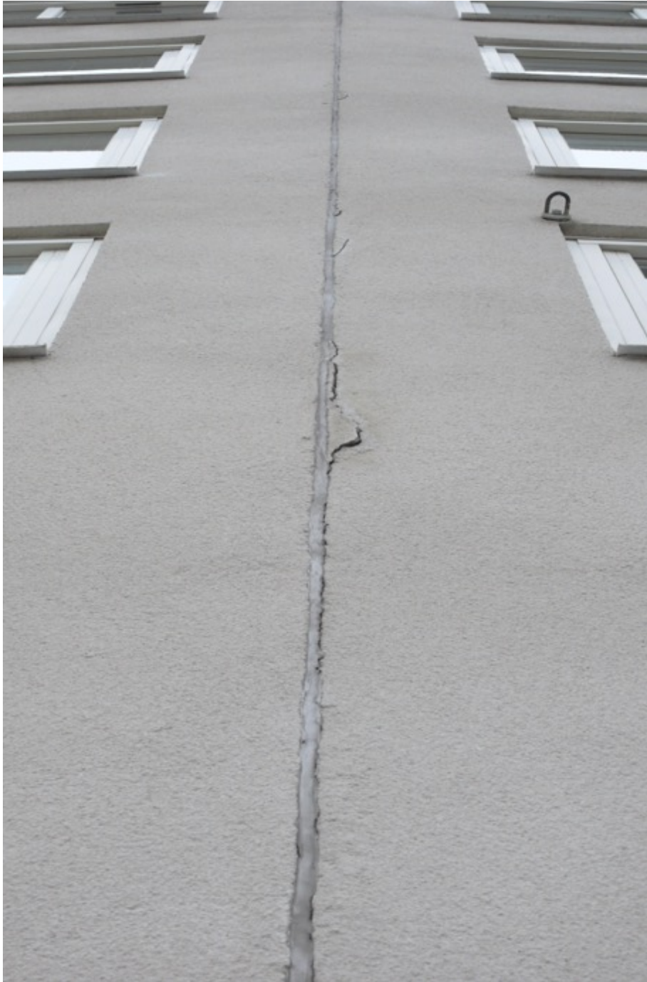
Bild 6. Sprickor och lös puts ovan entré till Vårdcentral. Risk för nedfallande puts och personskador.
