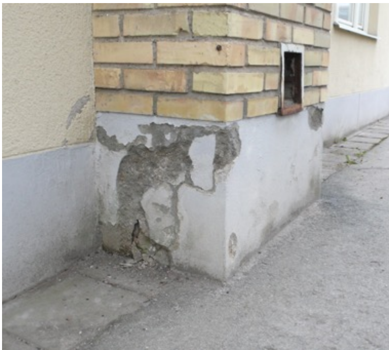
Bild 18. Sockelskador på skorstensfot.
