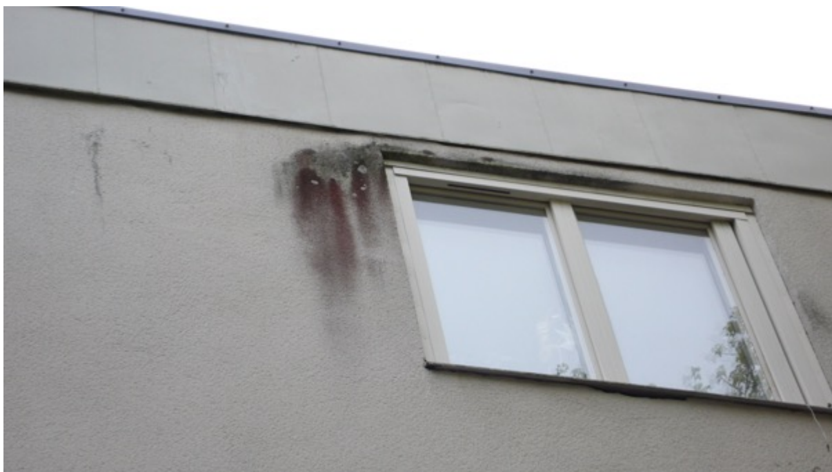
Bild 14. Större algpåväxt vid takfot och fönster ovan entré 20. Takfotsplåt har ej tillräckligt språng vilket leder till vattenläckage på fasad.
