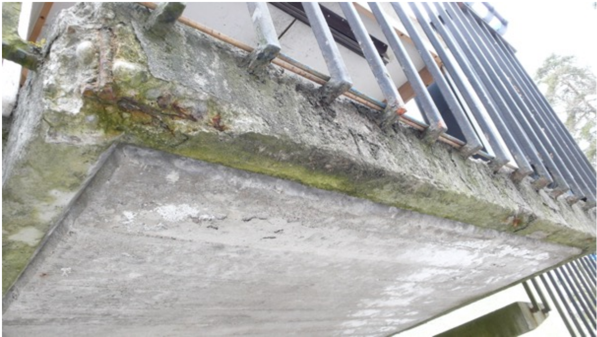
Bild 12. Sprickor i betongavsats samt rostande armering.
