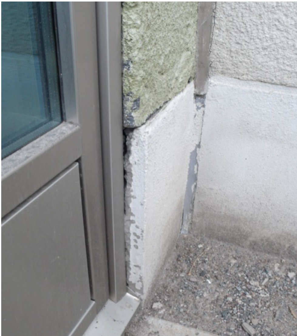
Bild 4. Löst sockelparti till höger om entré 28.
