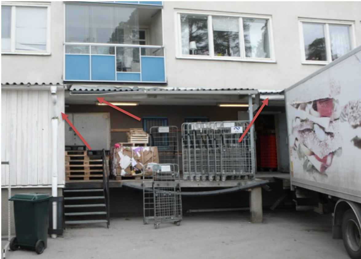
Bild 3. Skadat och ej fungerande stuprör samt skadade hänggränor vid varuintag COOP.
