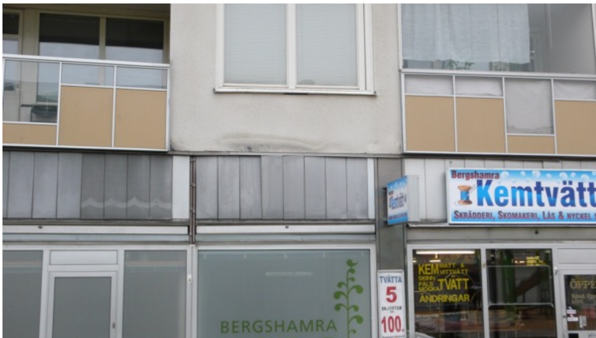
Bild 11. Fuktutslag ovan fasadplåt.
