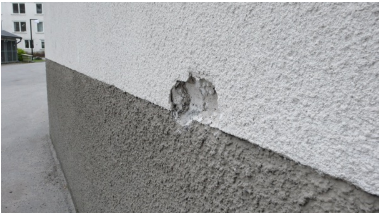
Bild 2. Mekanisk skada i puts vid varuintag COOP.
