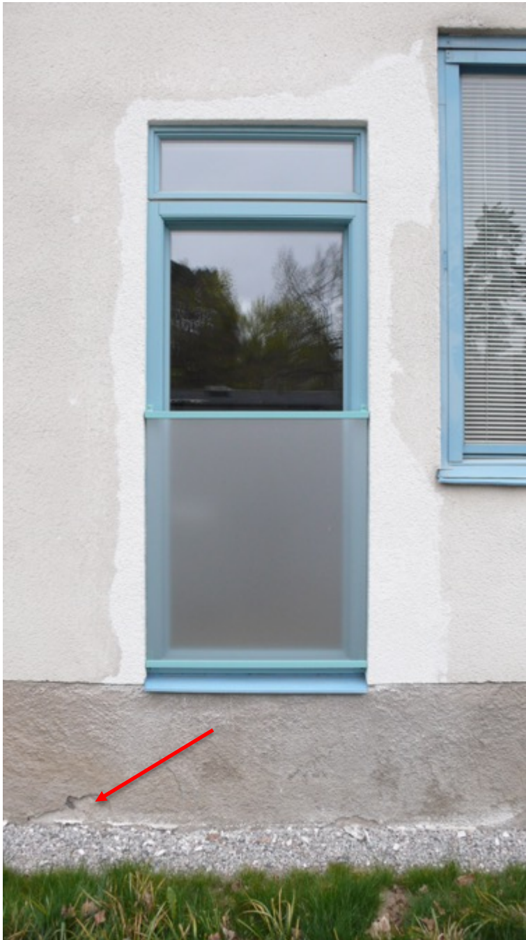
Bild 6. Sprucken och trasig puts i sockel. Putslagning runt nyinsatt fönster dörr med stor nyans skillnad.
