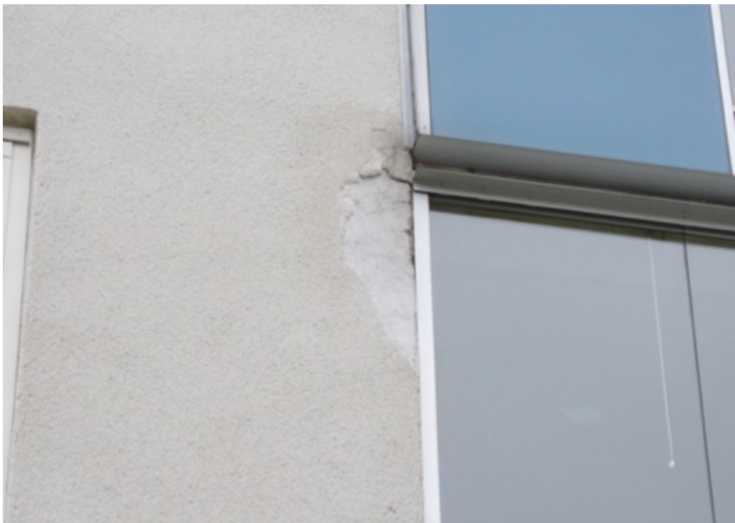
Bild 8. Putsskada vid balkong med lös puts som behöver knäckas ned och åtgärdas.
