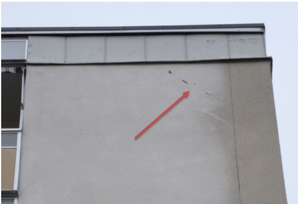
Bild 7. Större diagonal spricka från takfot till rörelsefog. Kräver ytterligare undersökning med tanke på orsak och allvarlighetsgrad.
