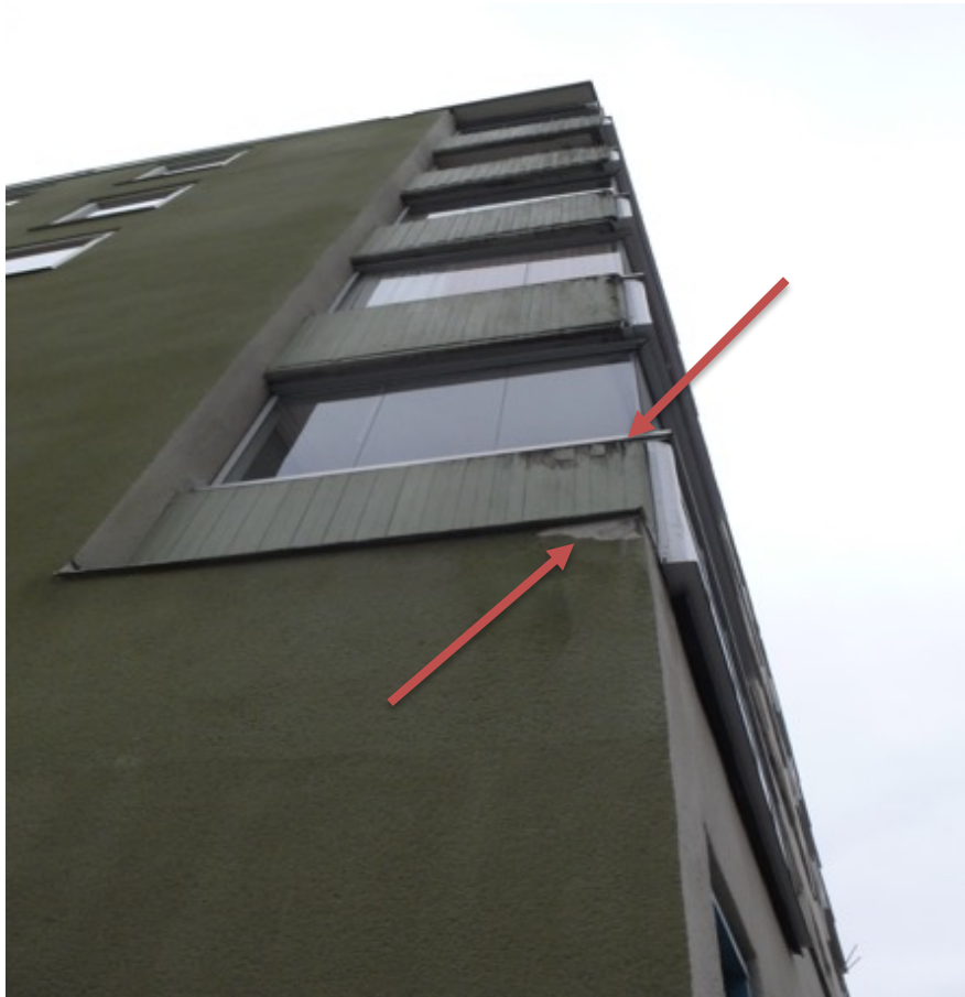
Bild 5. Algpåväxt och sprickor på balkongsidor samt putsskada under krönplåt vid balkong vid hörn mot sydväst.
