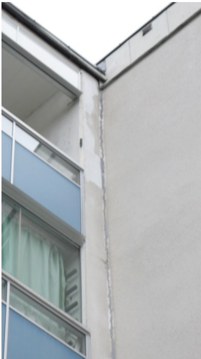
Bild 9. Ej färdigställd putslagning.
