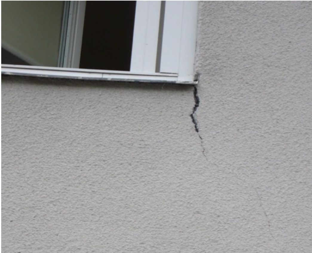
Bild 6. Större vertikal spricka med utgångspunkt ifrån fönsteröppning.
