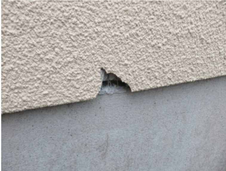
Bild 19. Hål i puts mot sockel.
