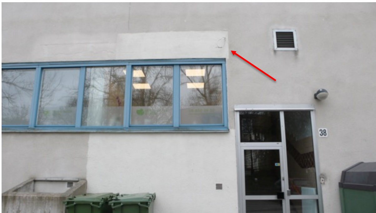
Bild 9. Löst hängande kabel ovan entré 38. Avfärgad fasadyta med avvikande nyans till vänster om entré 38.
