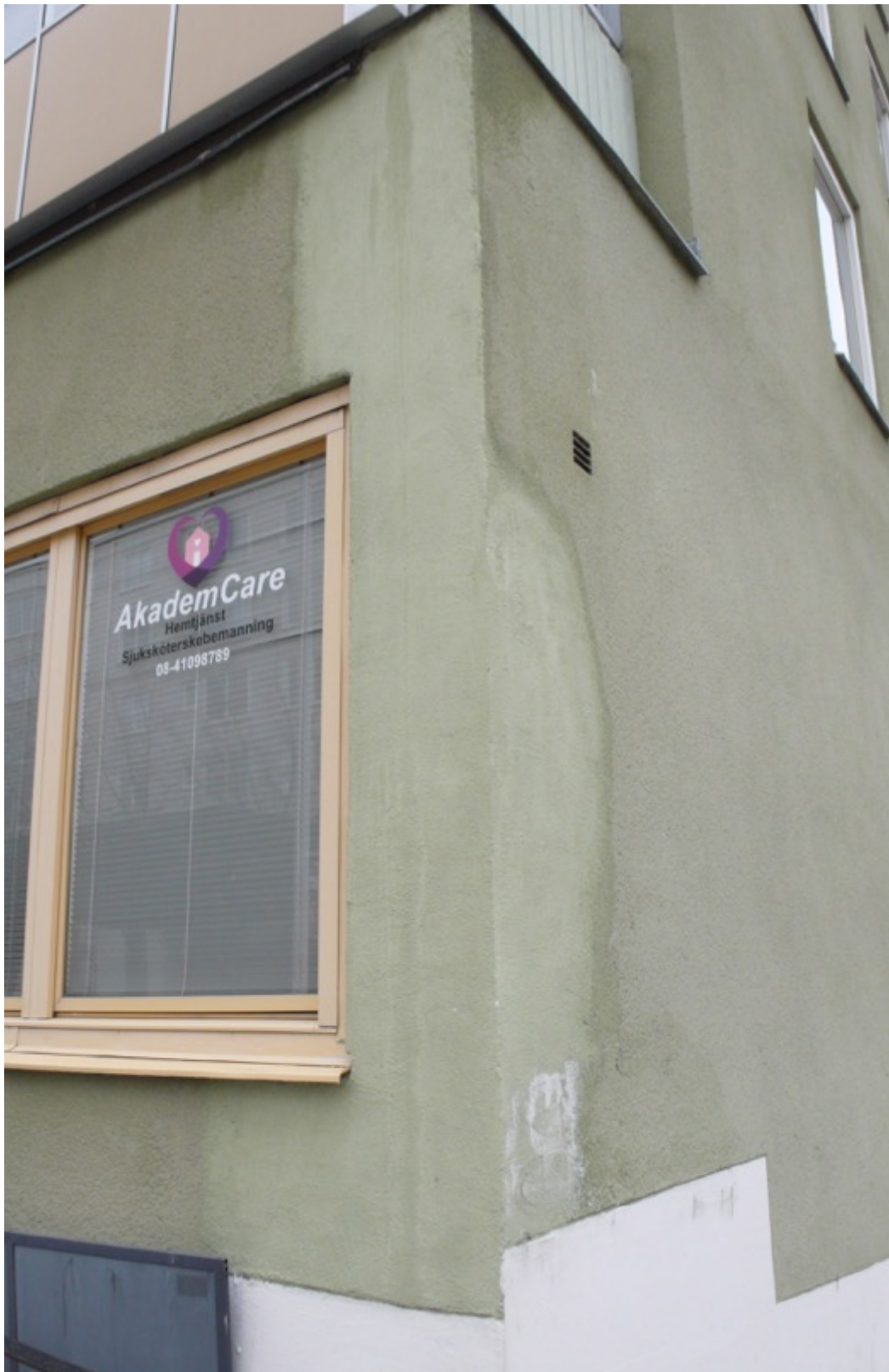
Bild 8. Putslagat hörn med avvikande struktur och nyans i avfärgning.
