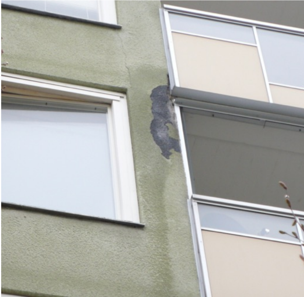
Bild 1. Putsskada med sprickbildning vid balkong ovan entré 24.
