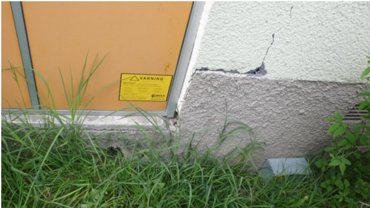
Bild 10. Skada i sockel med lös puts. Samt större hål under balkonggavel.
