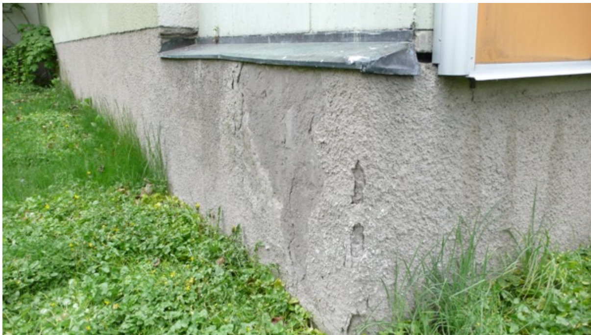
Bild 13. Skadad puts i sockel.
