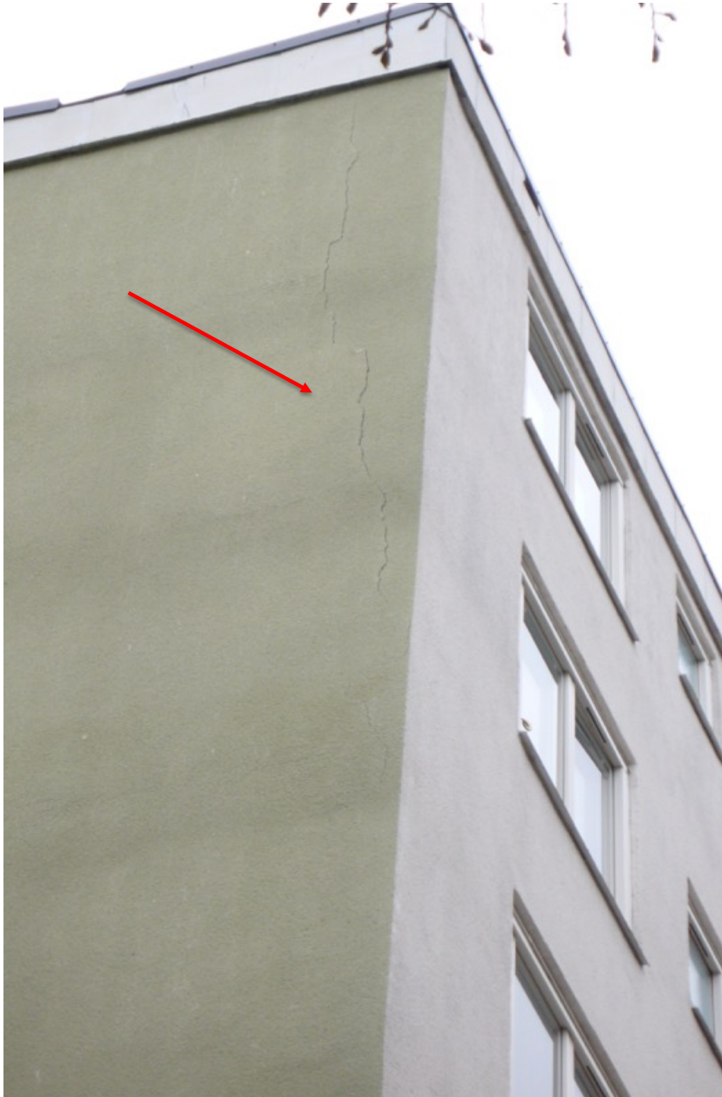
Bild 5. Större vertikal spricka. Kräver ytterligare undersökning med tanke på orsak och allvarlighetsgrad.
