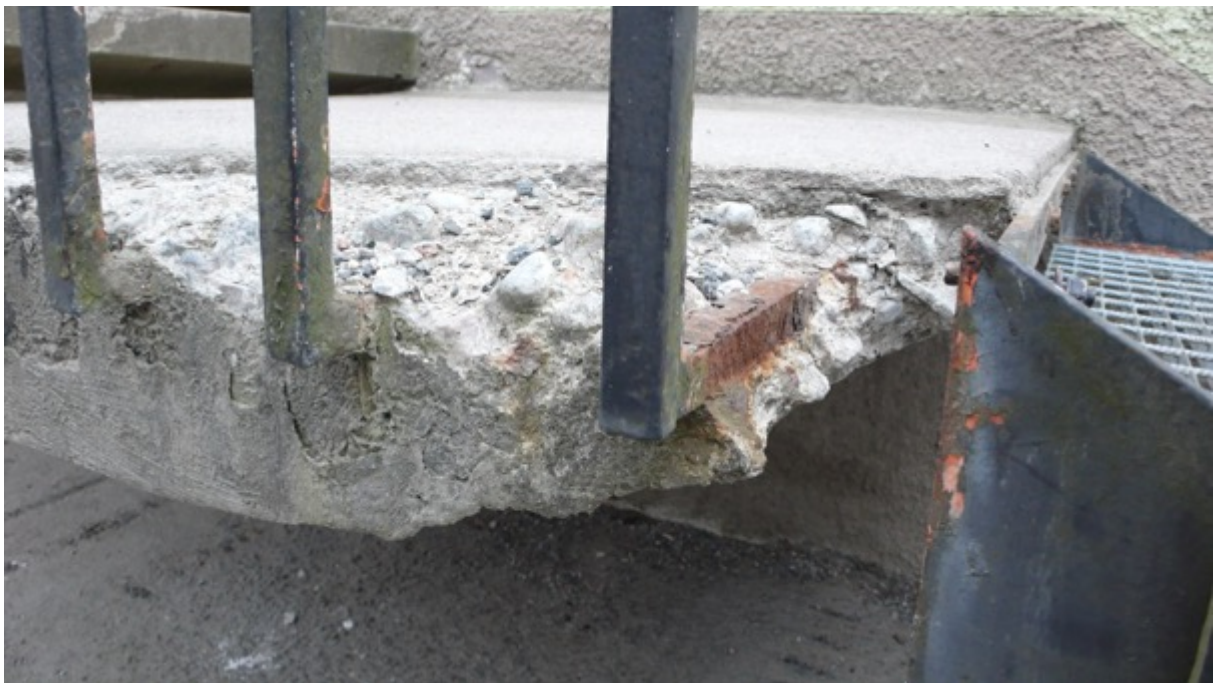
Bild 13. Sprucken och vittrande betongavsats samt rostande räcketinfästningar.
