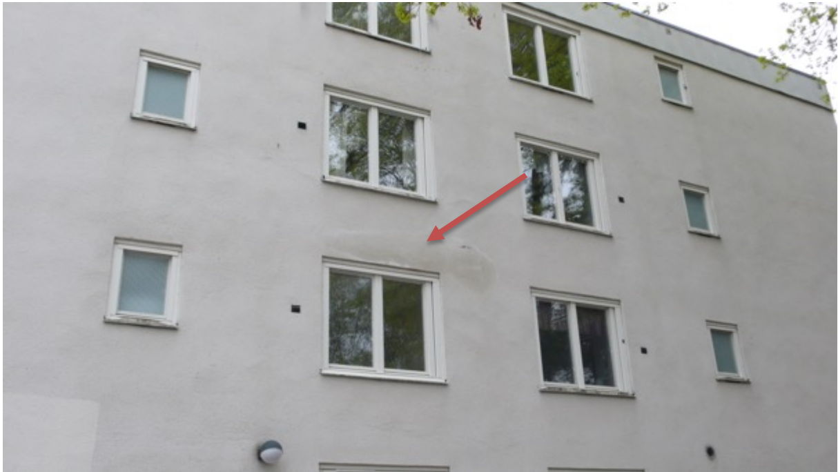
Bild 15. Fuktutslag i putsyta ovan fönster vid entré 20.
