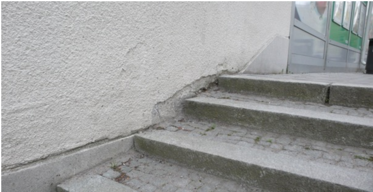
Bild 1. Putsskada vid trapp i gatuplan där sockel saknas.
