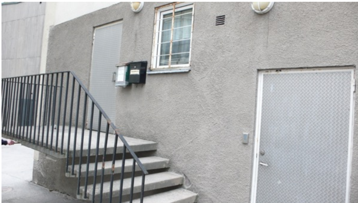
Bild 8. Fasadpartiet runt lastkajen och dörrar har omfattande sprickbildning samt lös puts.
