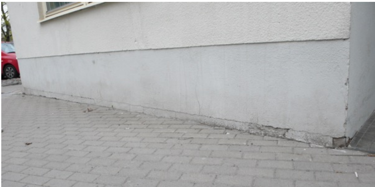
Bild 2. Spricka och skada längs mark i sockel till vänster om entré 24.
