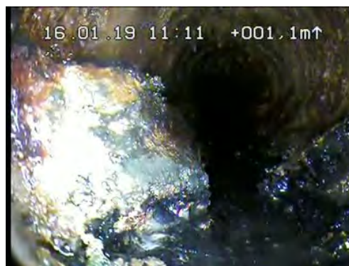
Bildnamn: 5_3_B, Videotid: 17;7757s Påbyggnad 3. Reduktion av rörets tvärsnittsarea som är från 15% och upp till 30%, klockan 08 .
