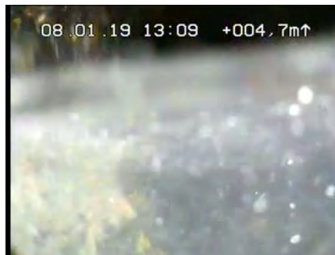
Bildnamn: 1_4_A, Videotid: 68;7694s Ytskada 4. Utbredda rostangrepp i gjutjärn.
