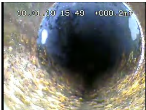
Bildnamn: 24_2_A, Videotid: 5;7818s Ytskada 2. Mindre rostangrepp i gjutjärn, börjar .
