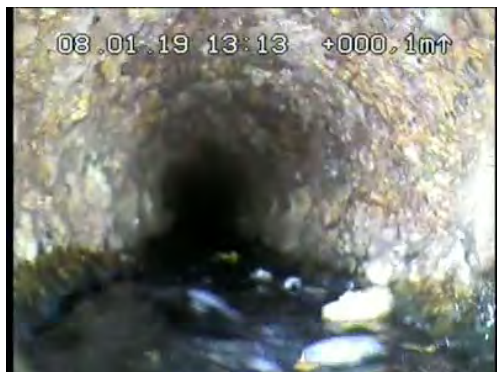
Bildnamn: 2_2_A, Videotid: 3;7695s Ytskada 3. Rostangrepp i gjutjärn, börjar .
