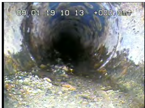
Bildnamn: 15_2_A, Videotid: 1;7699s Ytskada 2. Mindre rostangrepp i gjutjärn, börjar .
