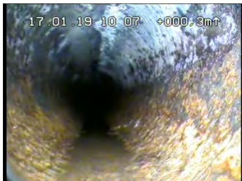
Bildnamn: 21_2_A, Videotid: 5;7764s Ytskada 2. Mindre rostangrepp i gjutjärn, börjar .
