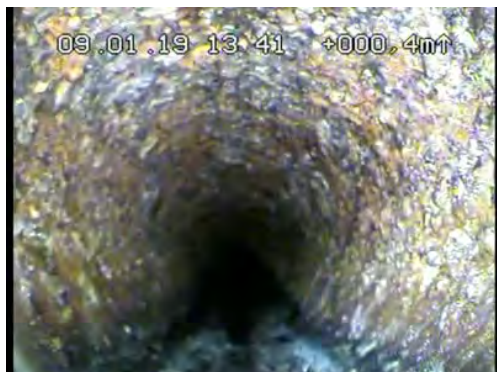
Bildnamn: 6_2_A, Videotid: 7;7701;770s Ytskada 4. Utbredda rostangrepp i gjutjärn, börjar .
