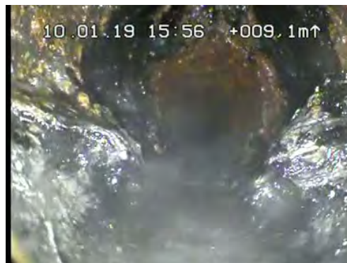
Bildnamn: 8_5_A, Videotid: 86;7728s Ytskada 4. Utbredda rostangrepp i gjutjärn.
