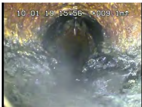
Bildnamn: 8_5_B, Videotid: 86;7728s Ytskada 4. Utbredda rostangrepp i gjutjärn.
