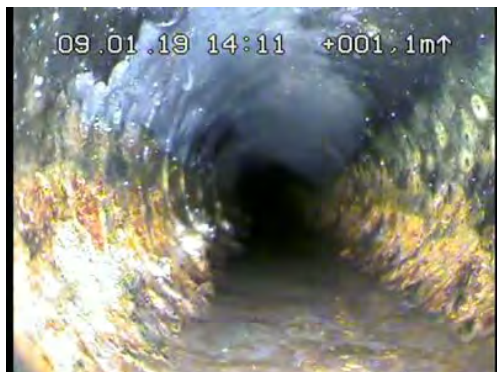
Bildnamn: 17_2_A, Videotid: 15;7705s Ytskada 2. Mindre rostangrepp i gjutjärn, börjar .
