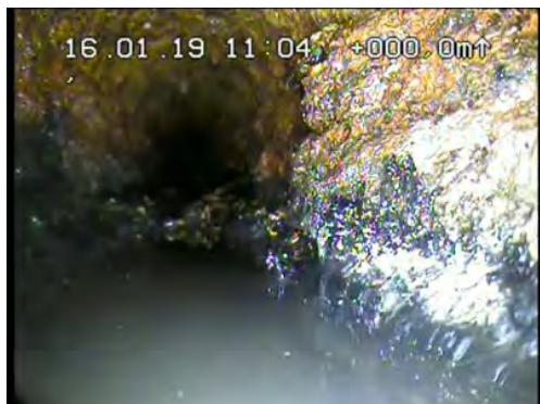
Bildnamn: 4_2_A, Videotid: 2;7756s Ytskada 4. Utbredda rostangrepp i gjutjärn, börjar .
