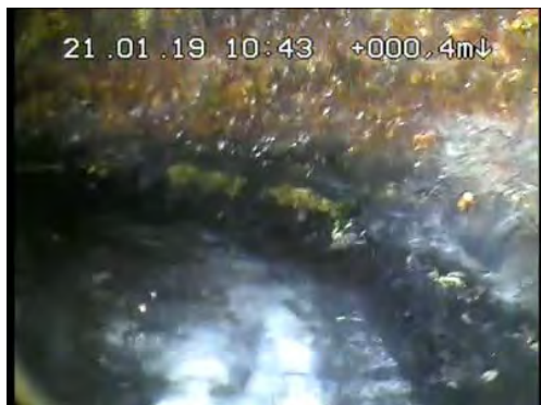
Bildnamn: 11_2_A, Videotid: 6;7820s Ytskada 4. Utbredda rostangrepp i gjutjärn, börjar .
