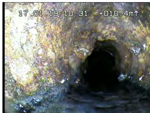
Bildnamn: 7_6_A, Videotid: 96;7765s Ytskada 4. Utbredda rostangrepp i gjutjärn.
