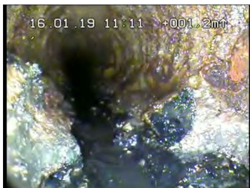
Bildnamn: 5_3_A, Videotid: 17;7757s Påbyggnad 3. Reduktion av rörets tvärsnittsarea som är från 15% och upp till 30%, klockan 08 .
