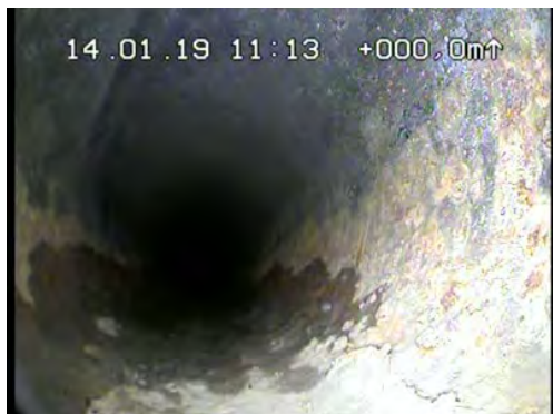
Bildnamn: 21_2_A, Videotid: 2;7738s Ytskada 2. Mindre rostangrepp i gjutjärn, börjar .
