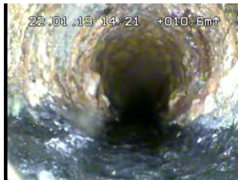
Bildnamn: 12_7_A, Videotid: 99;7856s Ytskada 4. Utbredda rostangrepp i gjutjärn.
