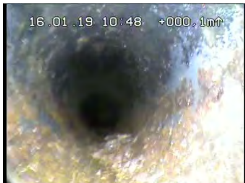
Bildnamn: 19_2_A, Videotid: 5;7755s Ytskada 2. Mindre rostangrepp i gjutjärn, börjar .
