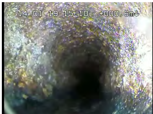
Bildnamn: 2_2_A, Videotid: 8;7741s Ytskada 3. Rostangrepp i gjutjärn, börjar .
