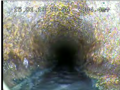
Bildnamn: 3_5_A, Videotid: 46;7753s Ytskada 3. Rostangrepp i gjutjärn, börjar .
