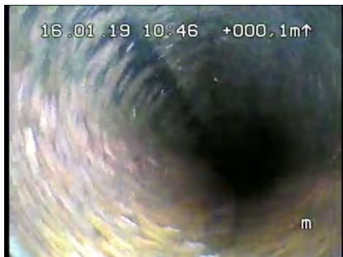
Bildnamn: 18_2_A, Videotid: 8;7754s Ytskada 2. Mindre rostangrepp i gjutjärn, börjar .
