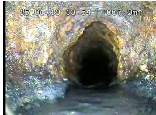
Bildnamn: 3_8_A, Videotid: 79;7753s Ytskada 4. Utbredda rostangrepp i gjutjärn.
