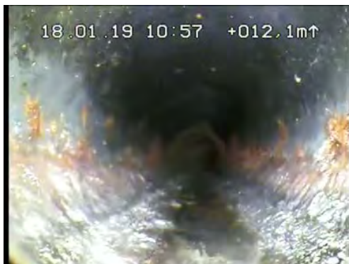
Bildnamn: 8_11_A, Videotid: 158;7812s Ytskada 3. Rostangrepp i gjutjärn, börjar .
