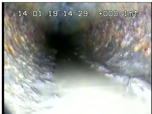
Bildnamn: 15_2_A, Videotid: 9;7739s Ytskada 2. Mindre rostangrepp i gjutjärn, börjar .
