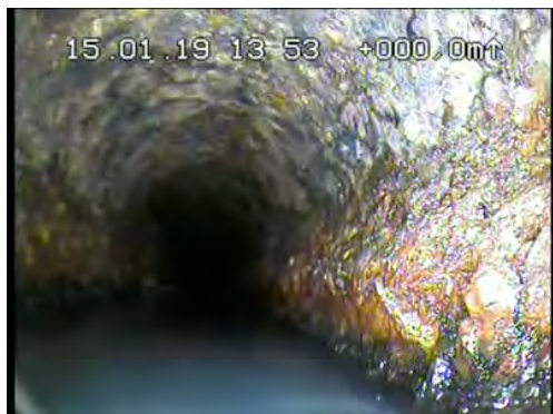
Bildnamn: 3_2_A, Videotid: 2;7753s Ytskada 4. Utbredda rostangrepp i gjutjärn, börjar .
