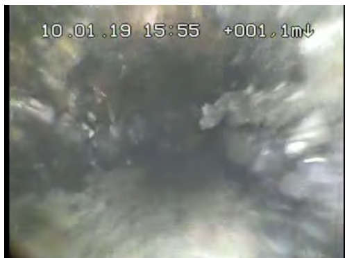
Bildnamn: 8_2_A, Videotid: 9;7728s Ytskada 3. Rostangrepp i gjutjärn, börjar .
