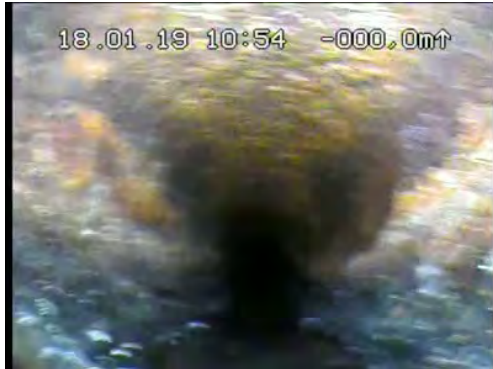
Bildnamn: 8_2_A, Videotid: 5;7812s Ytskada 4. Utbredda rostangrepp i gjutjärn, börjar .
