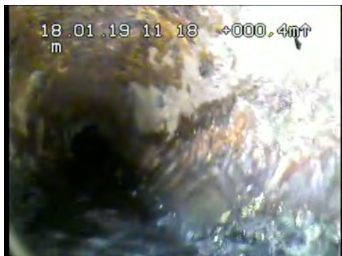
Bildnamn: 9_2_A, Videotid: 5;7813;781s Ytskada 4. Utbredda rostangrepp i gjutjärn, börjar .
