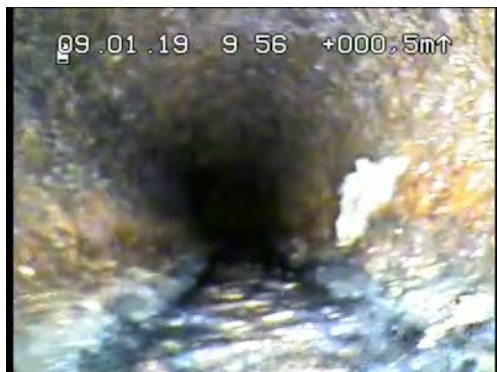
Bildnamn: 4_2_A, Videotid: 6;7698s Ytskada 3. Rostangrepp i gjutjärn, börjar .
