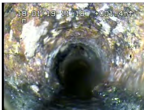
Bildnamn: 9_3_B, Videotid: 17;7813s Ytskada 4. Rörväggen är helt eller delvis uppfrätt eller att del av rörvägg saknas, klockan 03 .
