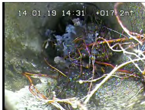
Bildnamn: 15_9_A, Videotid: 173;7739s Rötter 3. Reduktion av rörets tvärsnittsarea som är från 15% och upp till 30%, klockan 12-12 .
