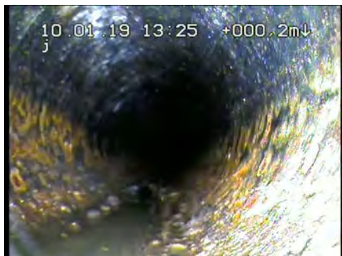
Bildnamn: 19_2_A, Videotid: 6;7708s Ytskada 2. Mindre rostangrepp i gjutjärn, börjar .
