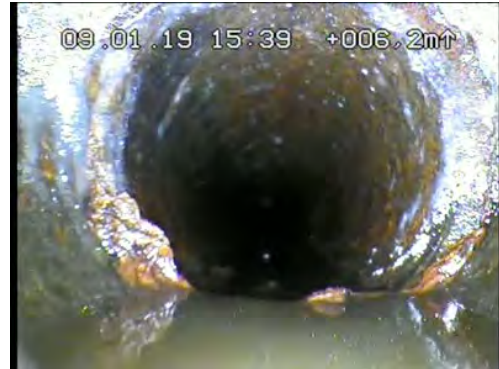
Bildnamn: 18_4_A, Videotid: 69;7706;77s Påbyggnad 3. Reduktion av rörets tvärsnittsarea som är från 15% och upp till 30%, klockan 07 .
