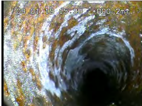
Bildnamn: 18_2_A, Videotid: 10;7706s Ytskada 2. Mindre rostangrepp i gjutjärn, börjar .
