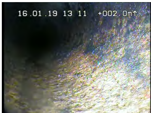
Bildnamn: 20_3_A, Videotid: 29;7760s Ytskada 2. Mindre rostangrepp i gjutjärn, börjar .
