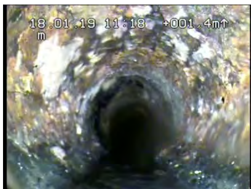
Bildnamn: 9_3_A, Videotid: 17;7813s Ytskada 4. Rörväggen är helt eller delvis uppfrätt eller att del av rörvägg saknas, klockan 03 .
