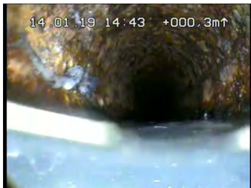
Bildnamn: 1_2_A, Videotid: 3;7740s Ytskada 3. Rostangrepp i gjutjärn, börjar .
