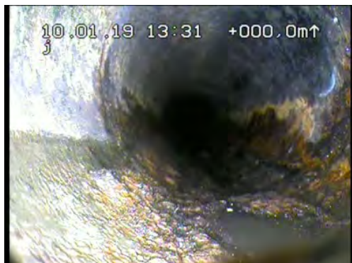
Bildnamn: 20_2_A, Videotid: 0;7709s Ytskada 2. Mindre rostangrepp i gjutjärn, börjar .
