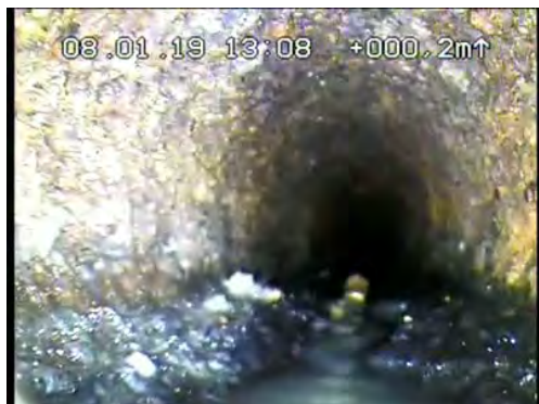
Bildnamn: 1_2_A, Videotid: 4;7694s Ytskada 3. Rostangrepp i gjutjärn, börjar .
