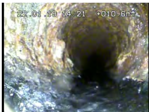
Bildnamn: 12_7_B, Videotid: 99;7856s Ytskada 4. Utbredda rostangrepp i gjutjärn.
