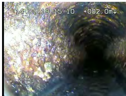
Bildnamn: 2_2_B, Videotid: 8;7741s Ytskada 3. Rostangrepp i gjutjärn, börjar .
