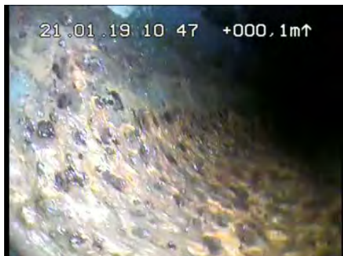
Bildnamn: 25_2_A, Videotid: 6;7821s Ytskada 2. Mindre rostangrepp i gjutjärn, börjar .
