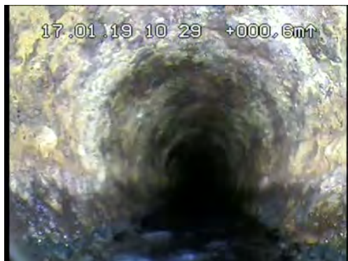
Bildnamn: 7_2_A, Videotid: 6;7765s Ytskada 3. Rostangrepp i gjutjärn, börjar .
