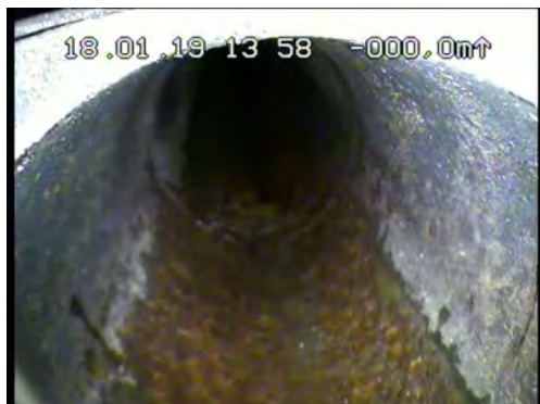
Bildnamn: 23_2_A, Videotid: 0;7815s Ytskada 2. Mindre rostangrepp i gjutjärn, börjar .
