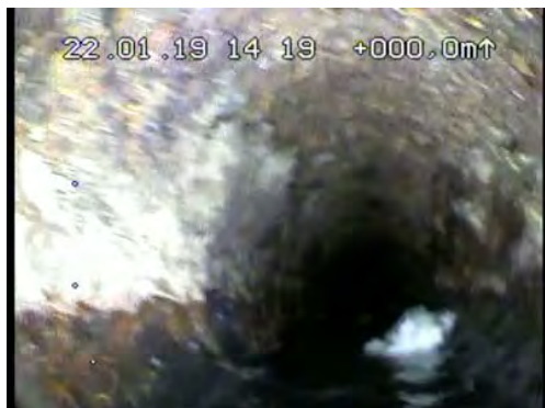
Bildnamn: 12_2_A, Videotid: 8;7856;785s Ytskada 3. Rostangrepp i gjutjärn, börjar .
