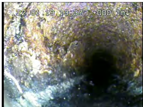
Bildnamn: 14_2_A, Videotid: 5;7859s Ytskada 4. Utbredda rostangrepp i gjutjärn, börjar .
