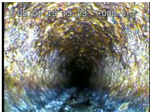
Bildnamn: 5_2_A, Videotid: 9;7700s Ytskada 4. Utbredda rostangrepp i gjutjärn, börjar .
