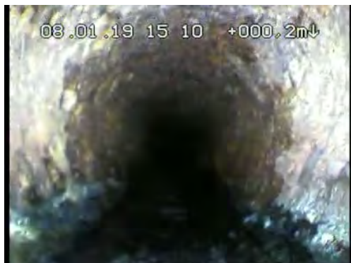
Bildnamn: 3_2_A, Videotid: 5;7697s Ytskada 3. Rostangrepp i gjutjärn, börjar .
