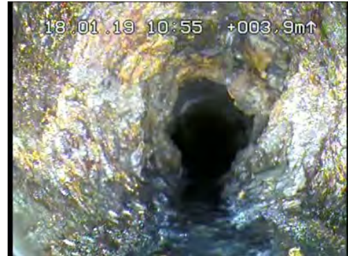
Bildnamn: 8_5_A, Videotid: 61;7812s Påbyggnad 4. Reduktion av rörets tvärsnittsarea som är från 30% eller större, klockan 12-12 .
