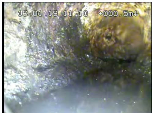
Bildnamn: 5_2_A, Videotid: 9;7757s Ytskada 4. Utbredda rostangrepp i gjutjärn, börjar .
