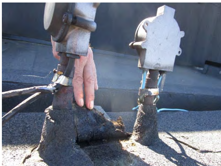
Foto 9. Flertal otäta anslutningar vid rör och kabelgenomföringar noterades.
