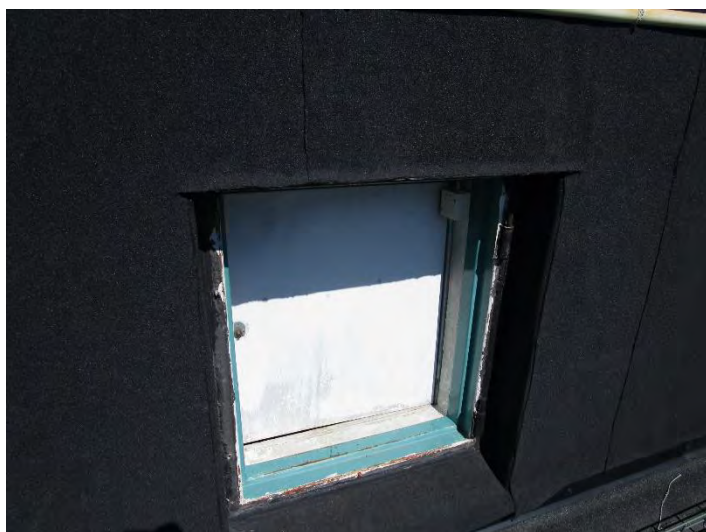
Foto 10. Björnstigen 30: Den yttre utstigningsluckan saknas och den inre luckan är trasig, går inte att låsa, obehöriga kan ta sig ut på taket. Säkerhetsaspekt.
