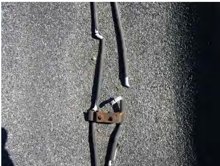
Foto 14. Värmekabelanläggning är av äldre modell och är ställvis skadad/trasig.
