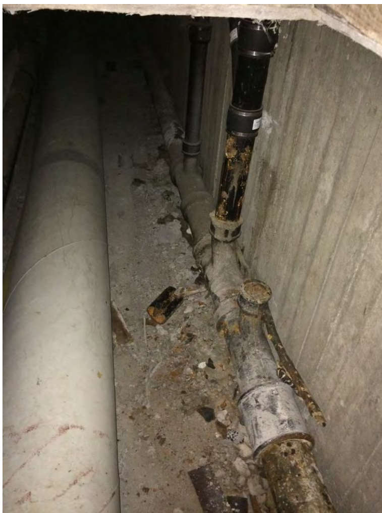
Horisontellt spillvattenrör i kulvert under källarbjälklag.
