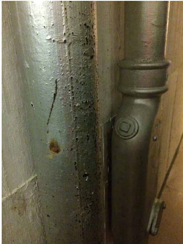
Stamledning i källare med rostgenomslag. Foton ej specifika för Torsken 2.
