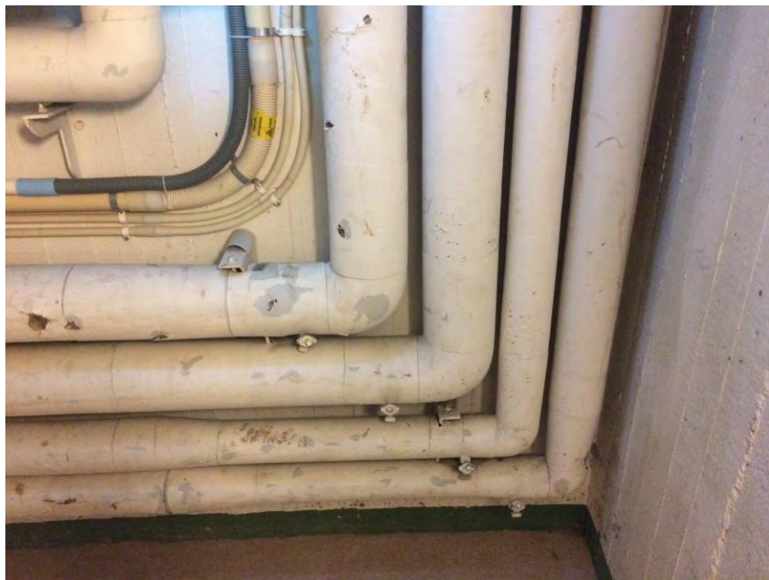
Isolerade rör i källarstråk.
