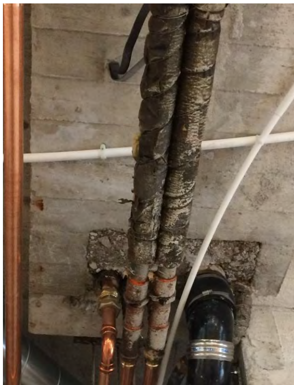
Isolerade värmerör i schakt o. dyl.
