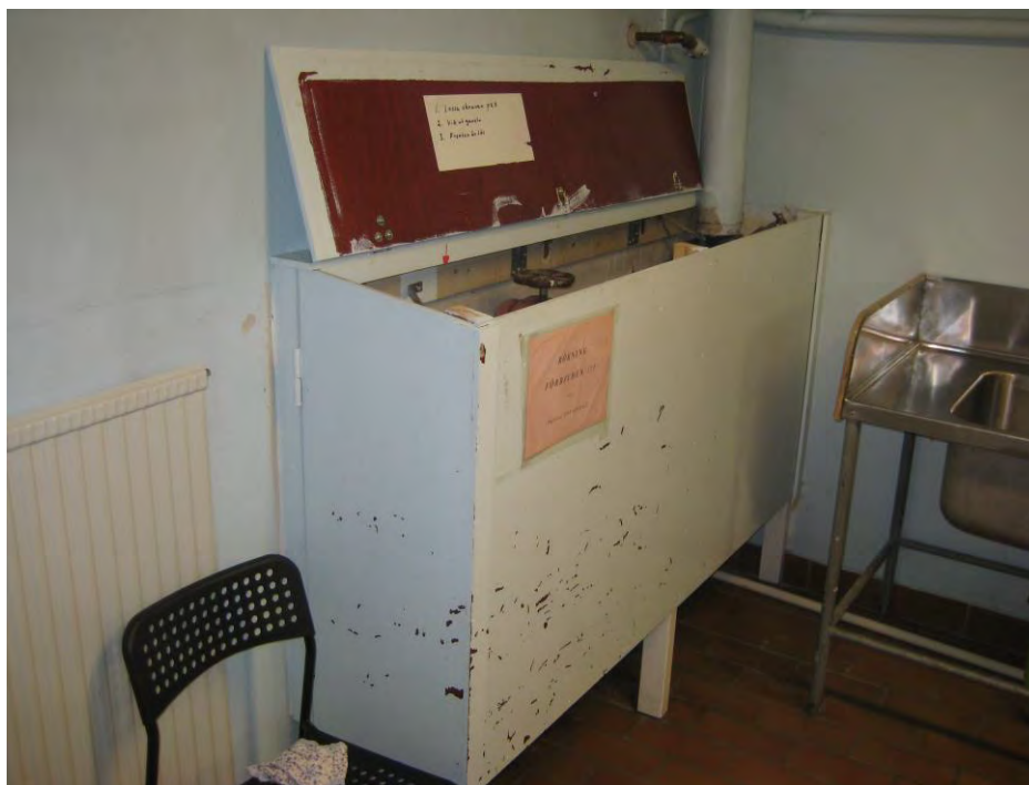
Tappvattenservis och servismätare väster i källare.
