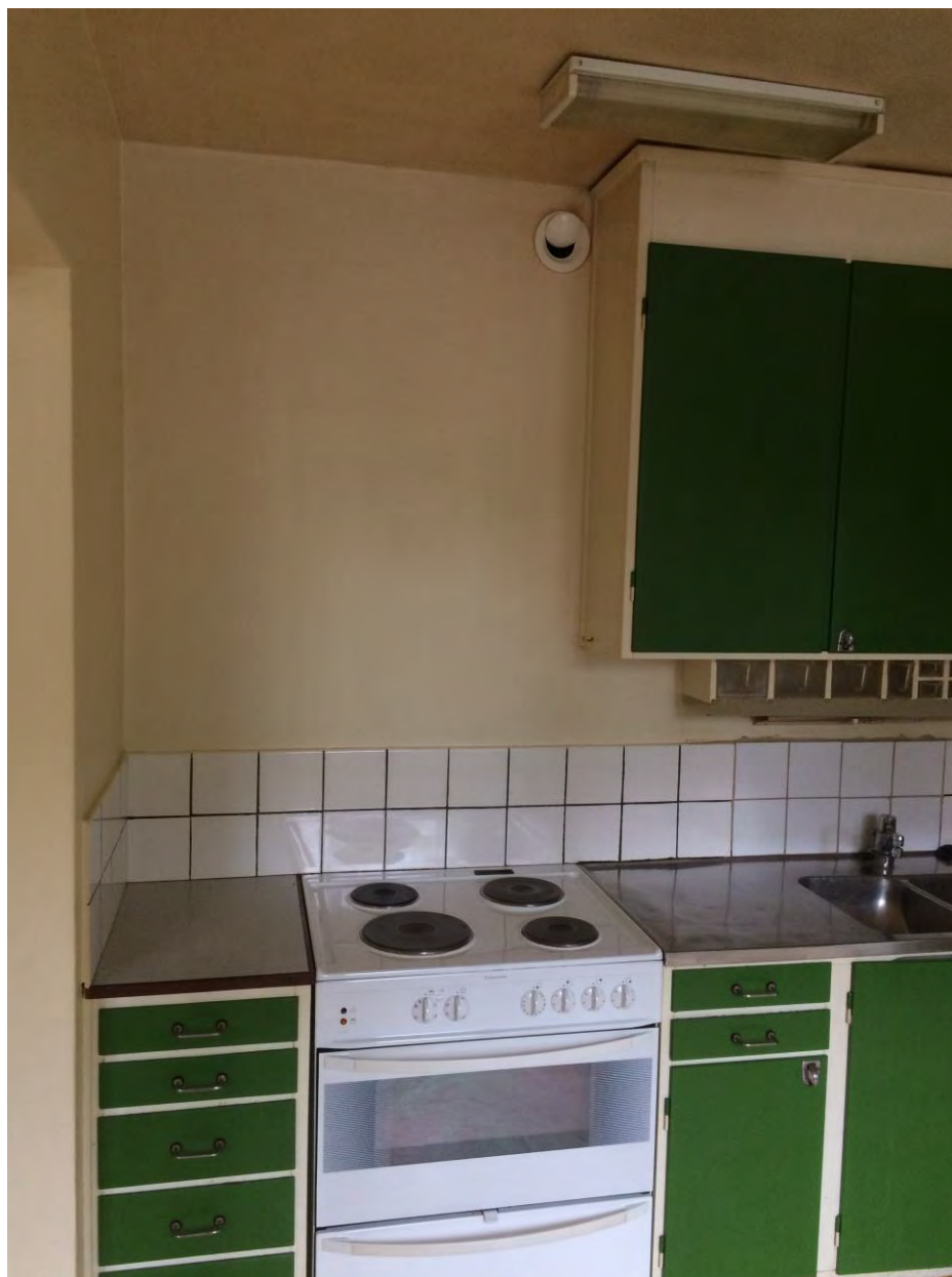
Frånluftsventil i kök.
