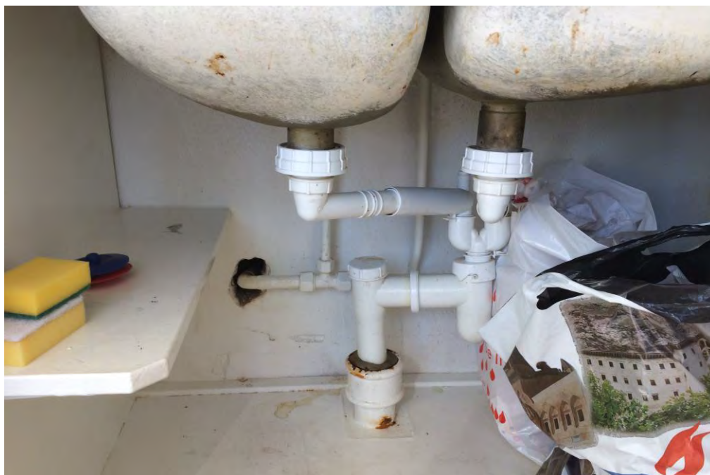
Avlopp under diskbänk, där gammalt vattenlås av gjutjärn bytts till plast. Obs, rostgenomslag på gjutjärnsröret.
