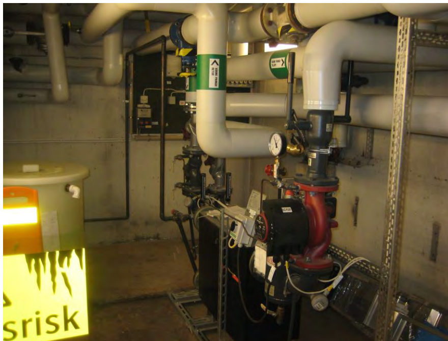
En av de två undercentralerna.
