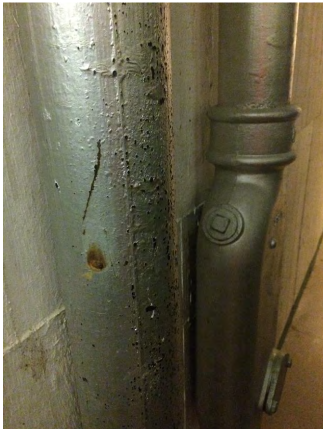
Stamledning i källare med rostgenomslag. Foton ej specifika för Torsken 5.
