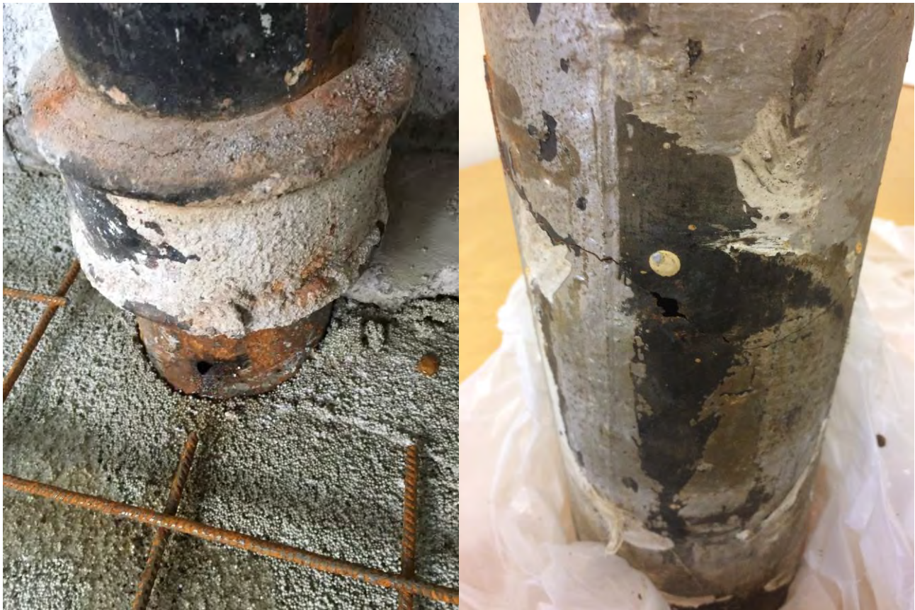
Foto vänster: Vid renovering av lgh stötte armeringsnät mot bef. avloppsrör och orsakade hål. Foto höger: Utbytt del av stamledning med rosthål. Foton ej specifika för Torsken 3.
