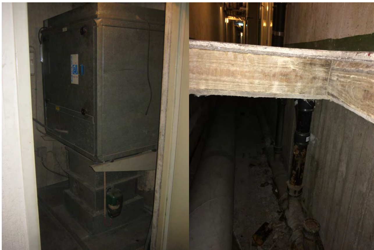
Foto vänster, frånluftsfläktar i källarplan. Foto höger, ventilationskulvert under källarkorridor. Foton ej specifika för Torsken 2.
