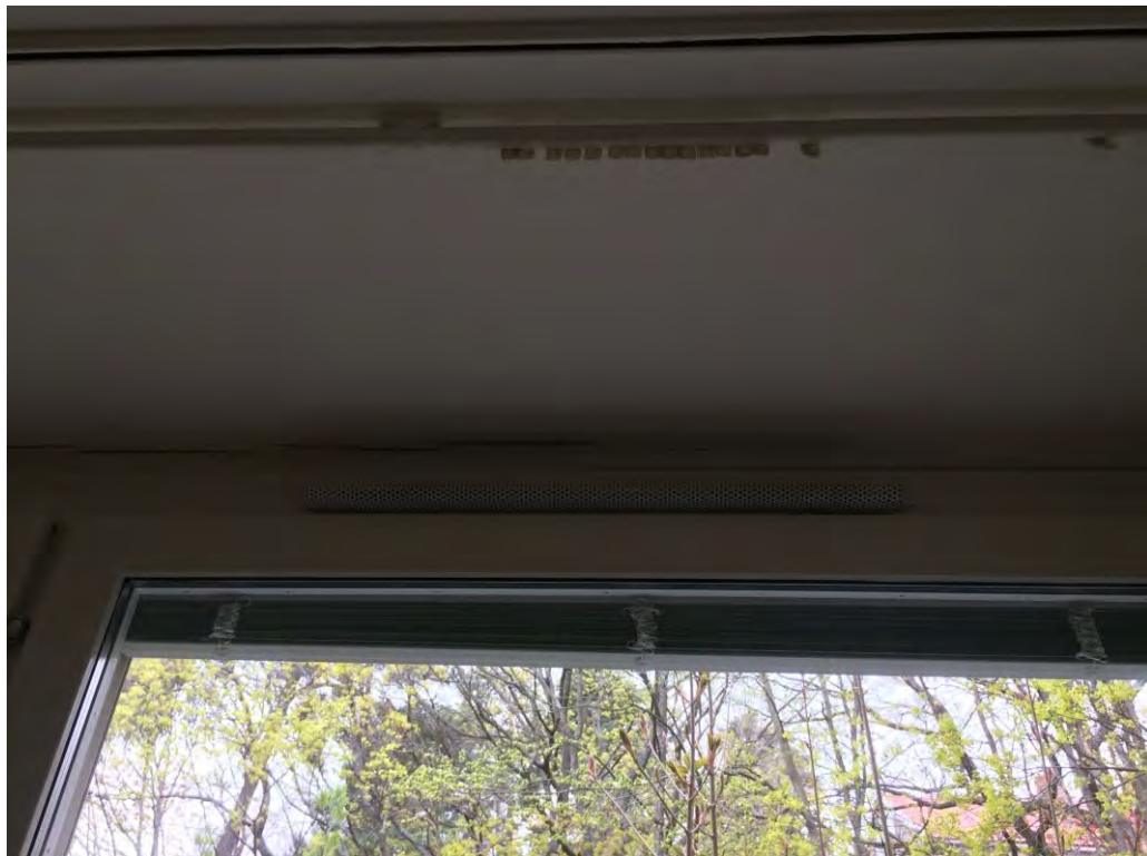
Tilluftsventil (spaltventil) i fönster.
