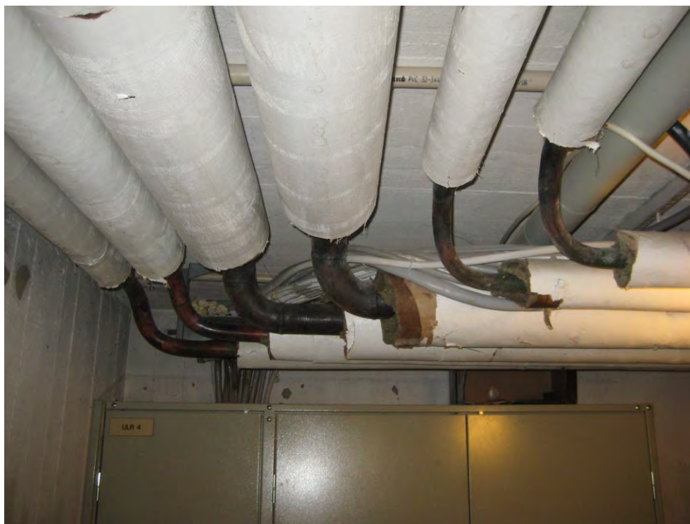
Isolerade rör i källarstråk.
