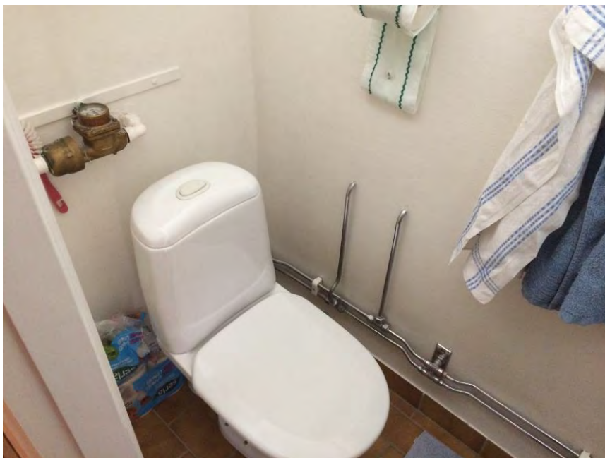
Vattenklossett och förkromade kopparrör för tappvatten. Obs den äldre tappvarmvattenmätaren (avläses ej).
