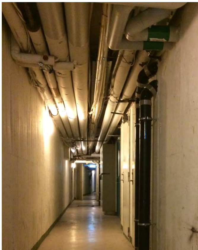
Isolerade rör i källarstråk.
