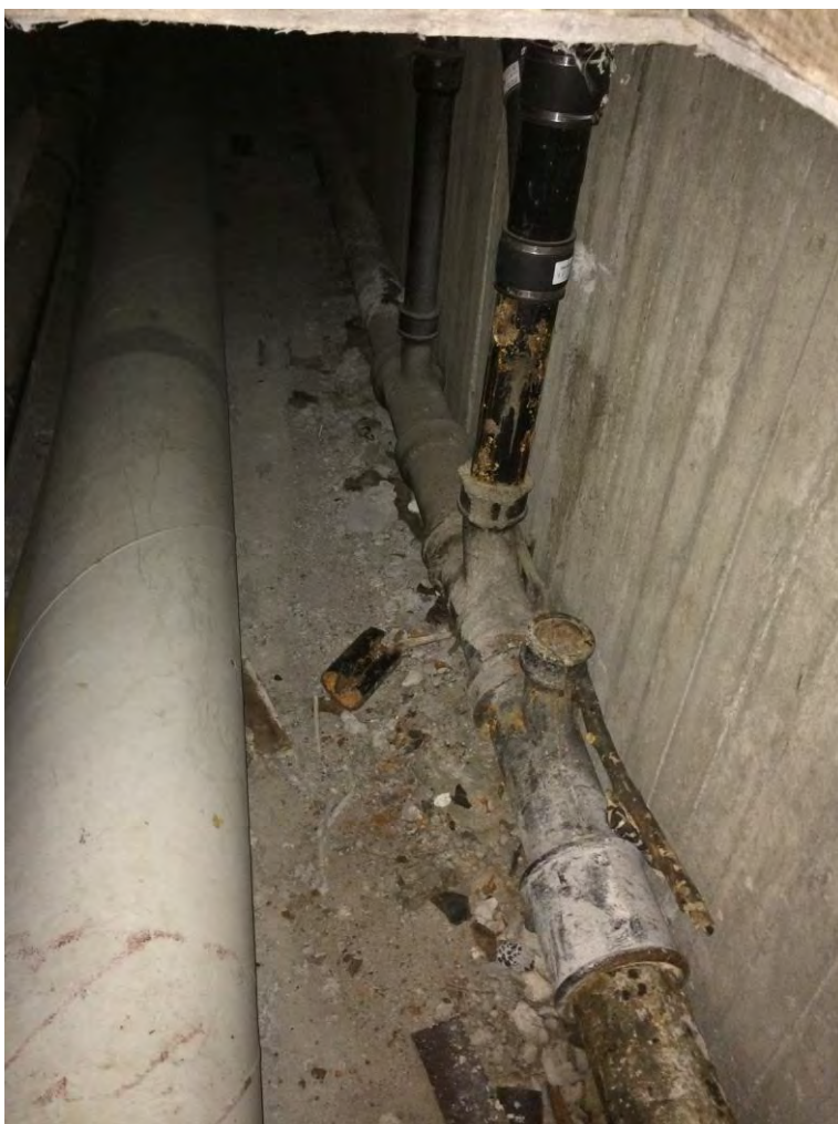
Horisontellt spillvattenrör i kulvert under källarbjälklag.
