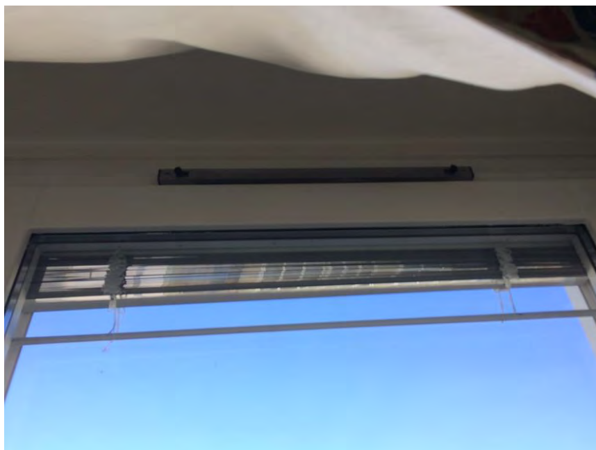
Tilluftsventil (spaltventil) i fönster.
