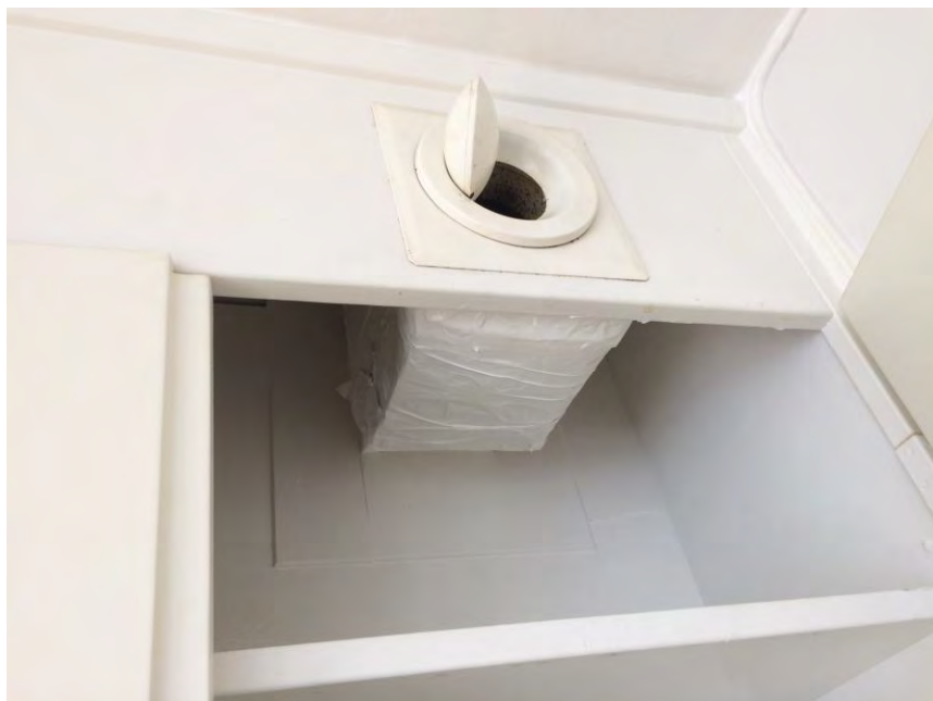
Frånluftsventil i kök med tejpad frånluftskanal.
