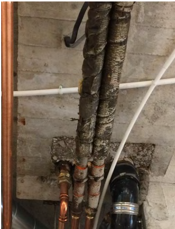
Isolerade värmerör i schakt o. dyl. Foto ej specifik för Torsken 3.
