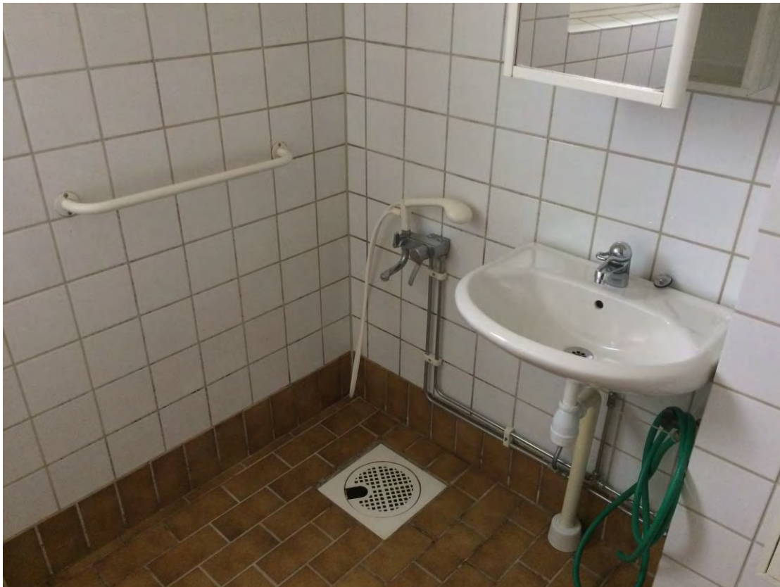
Duschblandare, golvbrunn och tvättställ.
