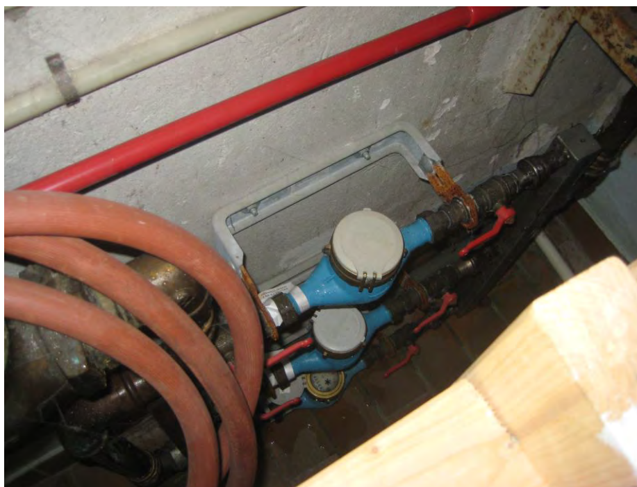
Tappvattenservis och servismätare väster i källare.
