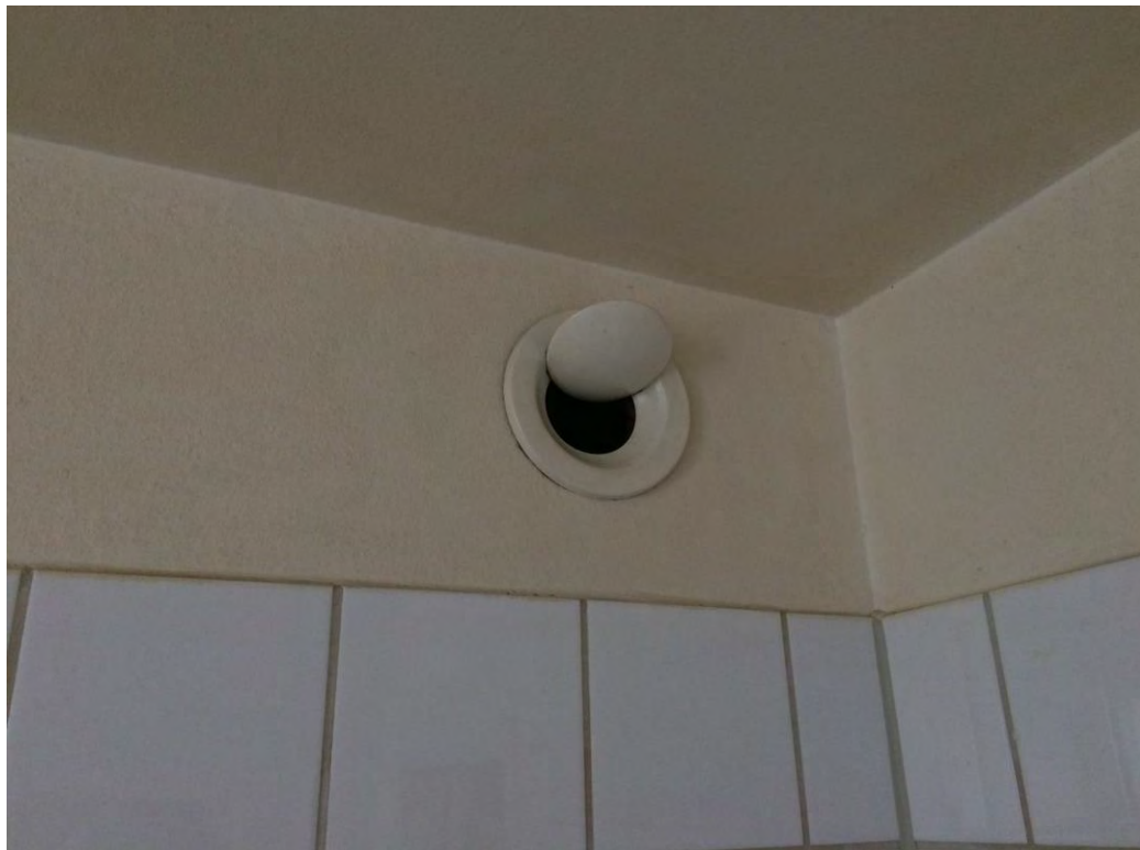
Frånluftsventil i badrum.
