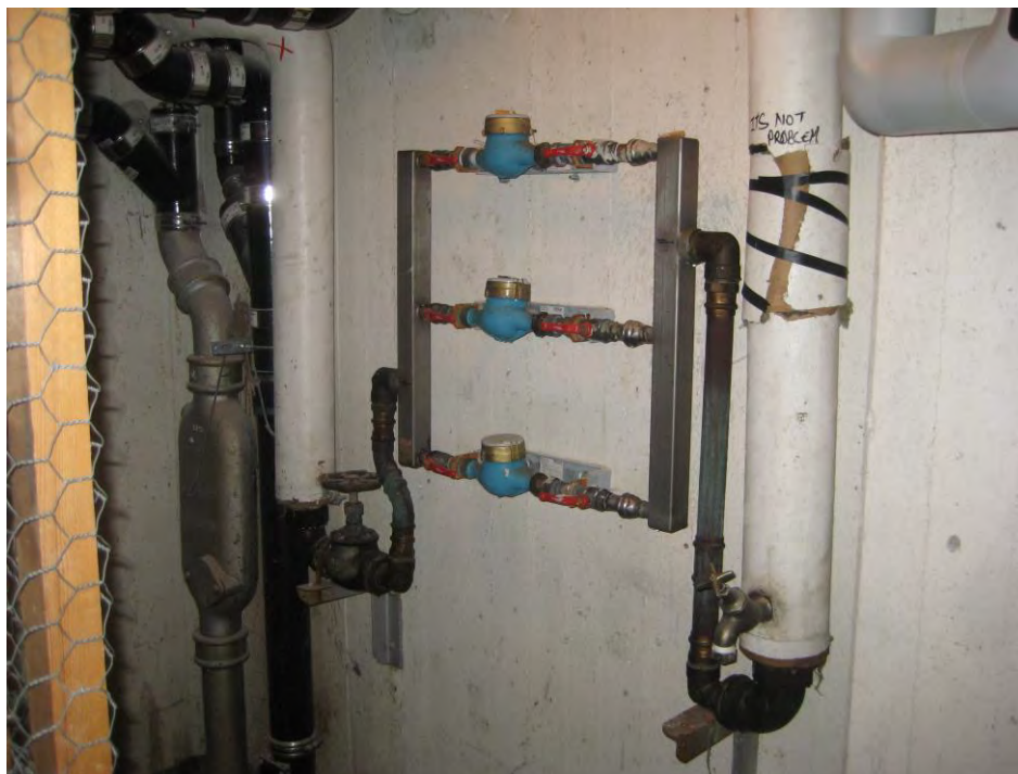
Tappvattenservis och servismätare öster i källare.
