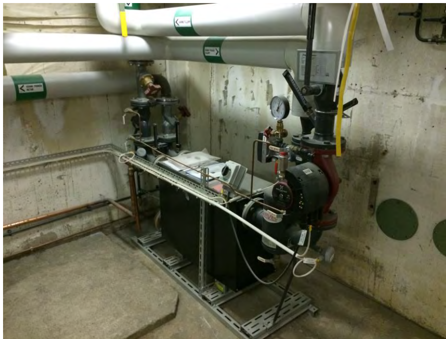
En av de tre undercentralerna.
