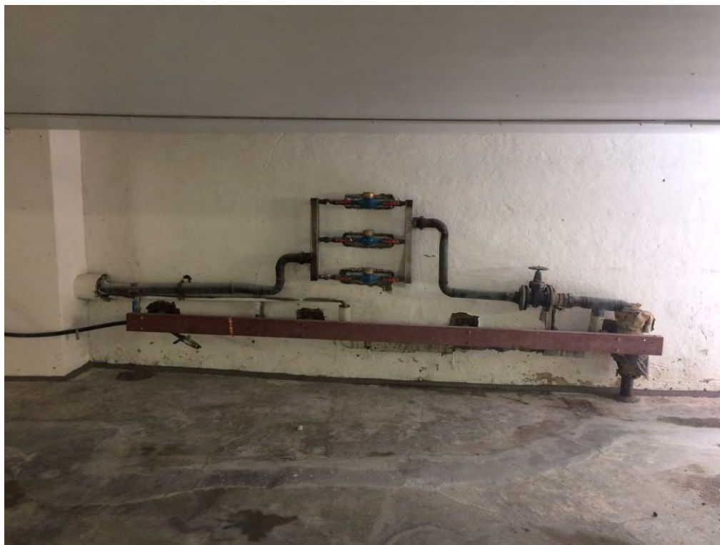
Tappvattenservis och servismätare i garage.
