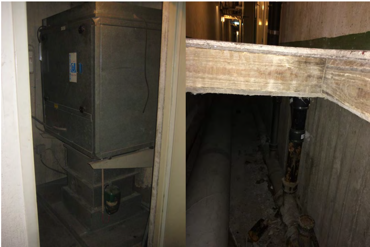
Foto vänster, frånluftsfläktar i källarplan. Foto höger, ventilationskulvert under källarkorridor. Foton ej specifika för Torsken 3.
