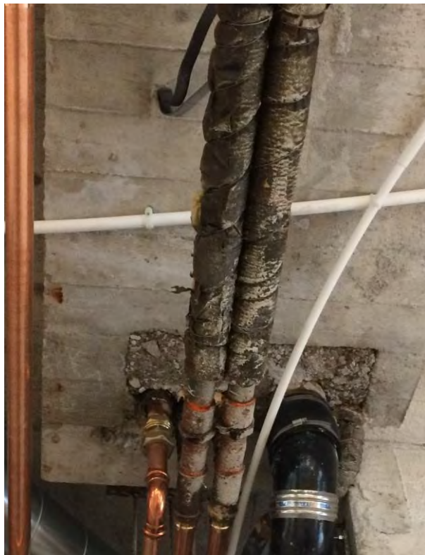
Isolerade värmerör i schakt o. dyl.
