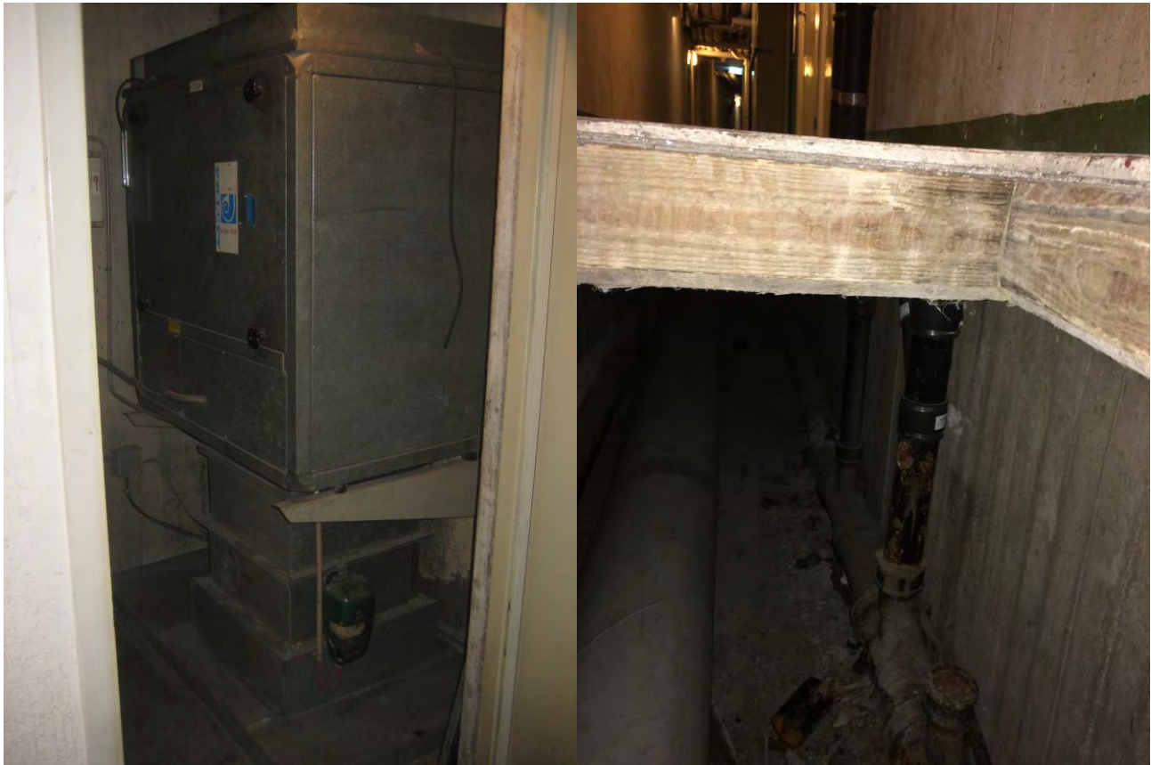
Foto vänster, frånluftsfläktar i källarplan. Foto höger, ventilationskulvert under källarkorridor. Foton ej specifika för Torsken 5.
