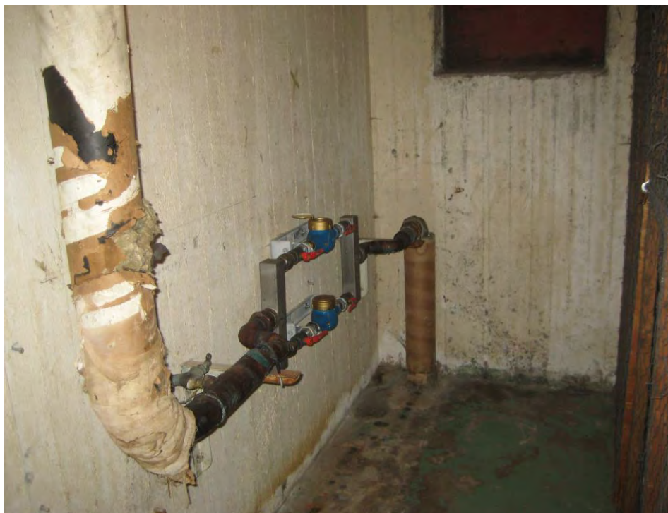
Tappvattenservis och servismätare i källare.
