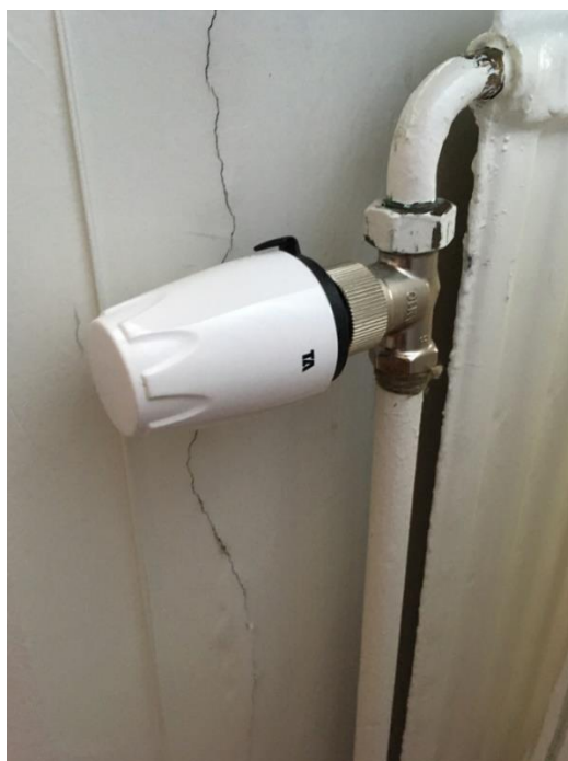
(Bild 20) Bagartorpsringen 80. Original panelradiator i lgh med ny termostat.
