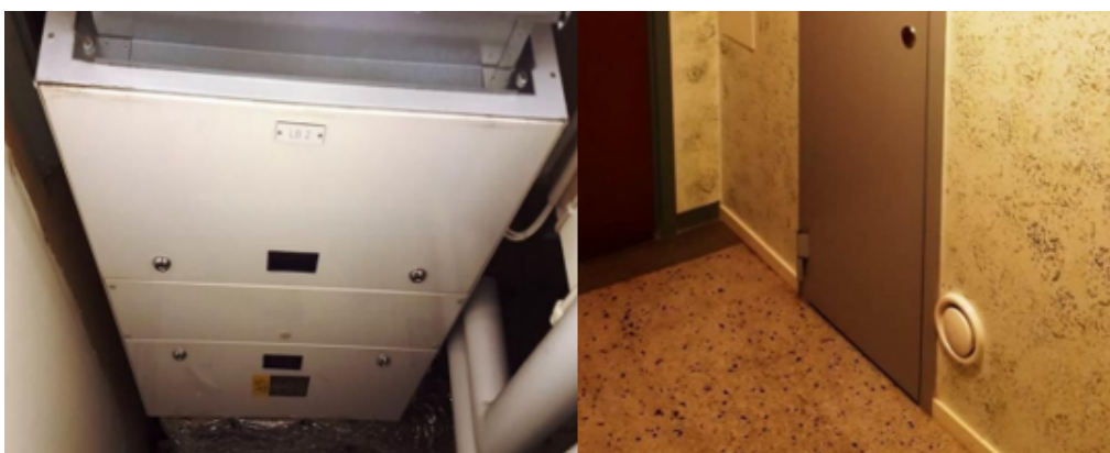
(Bild 26) Bagartorpsringen 80. LB2 i bottenvåning samt lågt sittande tilluftsdon.
