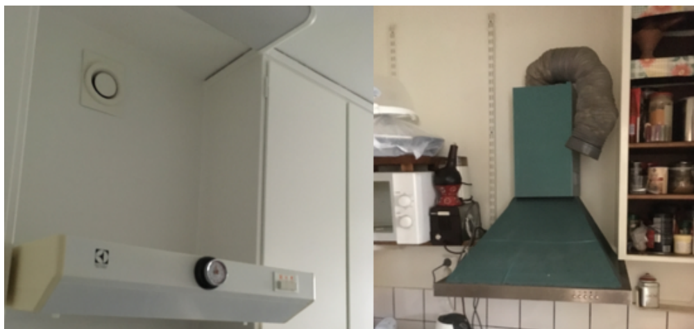
(Bild 28) Frånluftsventil kopplad till FTX på vindsplan samt tryckande köksfläkt som ej får förekomma.
