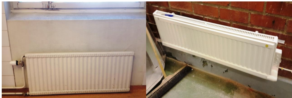
(Bild 17) Bagartorpsringen 78. Felmonterad radiator och nyare installerad radiator.
