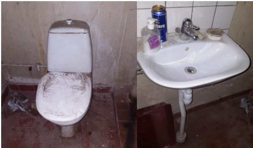
(Bild 09) Ett av många utrymmen i källare som är i dåligt skick.
