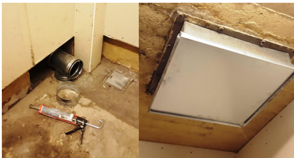
(Bild 31) Bagartorpsringen 70. Sugkammare där kanaler i bjälklag mynnar ut samt proppad genomföring från gammal frånluftsfläkt.
