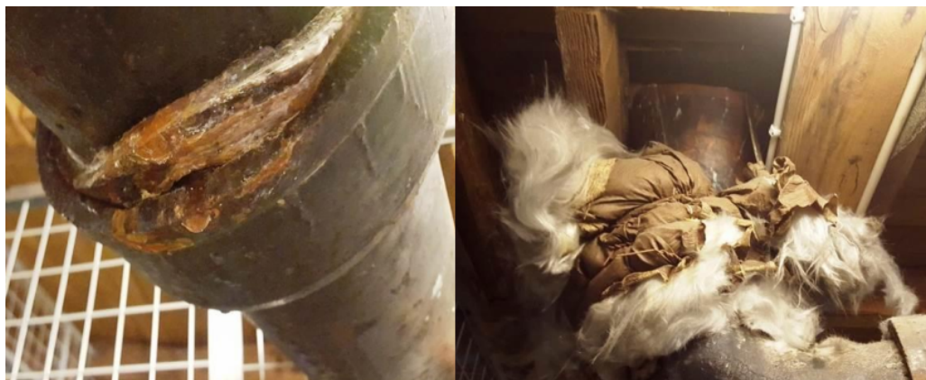
(Bild 12) Bagartorpsringen 58. Läckande stam samt läckande takbrunn med fuktuppfång.
