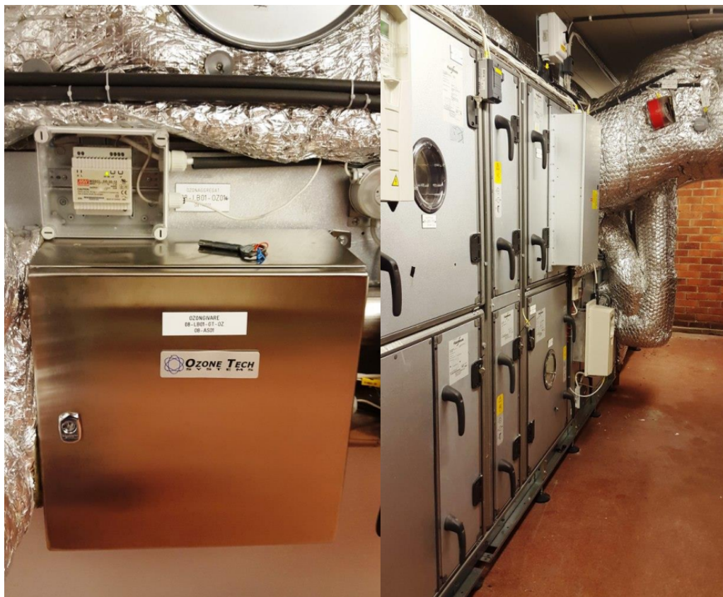
(Bild 29) Bagartorpsringen 70. LB1 med elbatterier.
