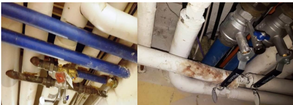
(Bild 02) Bagartorp 58. Blandat material på rör i källare.
