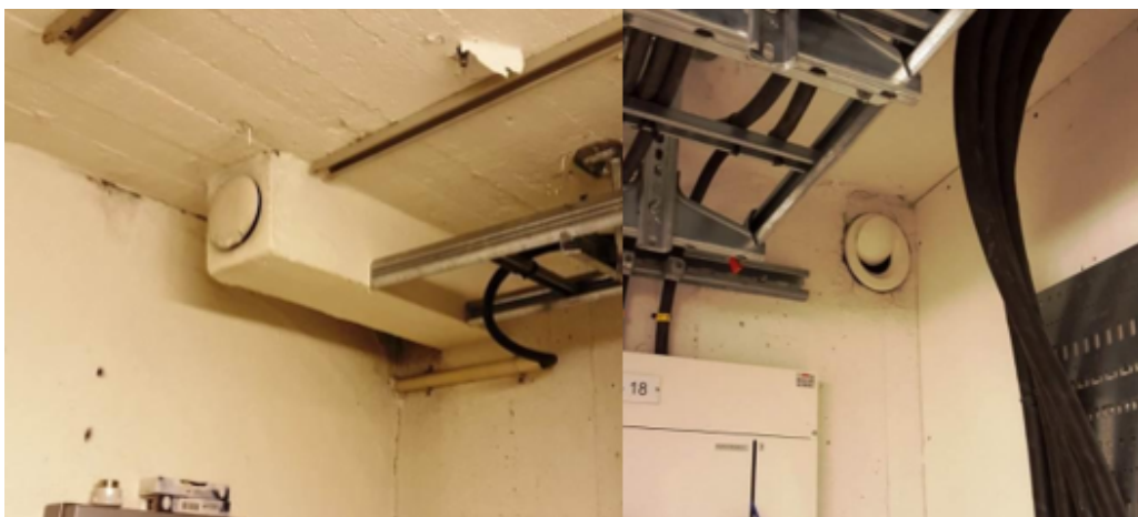
(Bild 25) Bagartorpsringen 80. Ytterväggsdon för självdrag samt frånluft mekanisk ventilation kopplad till FTX som servar lägenheter.
