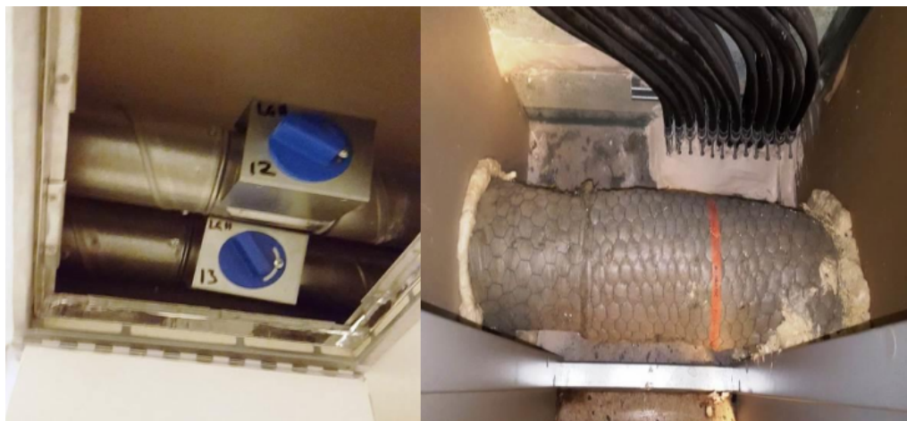
(Bild 27) Bagartorpsringen 80. Injusteringsspjäll i undertak sam tilluftskanal in till lägenhet.
