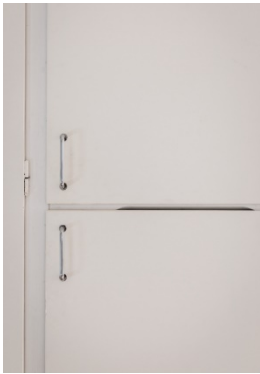
Befintliga garderobsluckor med bygelhandtag
