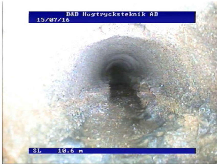
Bild på liggande S160 samlingsledning i gjutjärn under platta hus 15.
