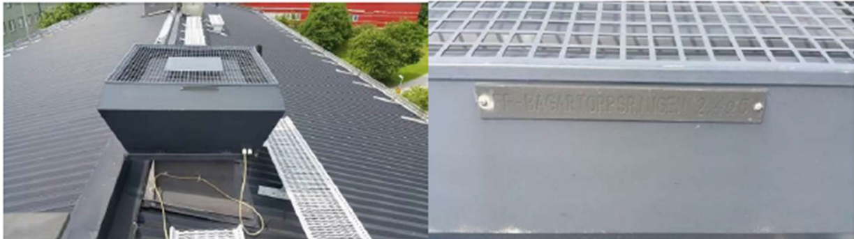
Bild på befintlig frånluftsfläkt och dess märkplåt.
