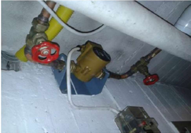
Bild på kompletterad VVC-pump i källarstråk för hus 16.
