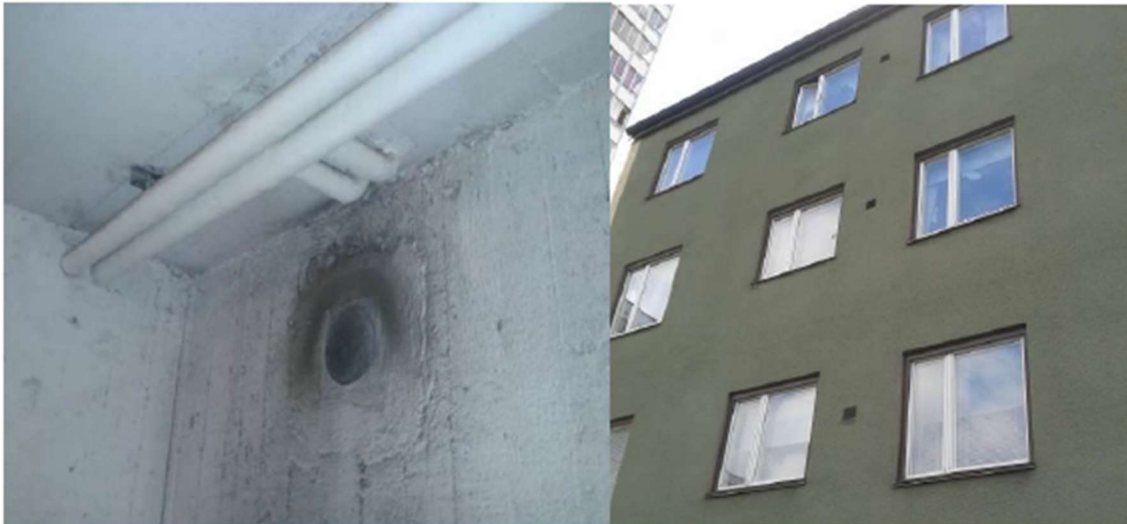
Vänster bild: Bild på friskluftsventil i fasadvägg för källarurymme.
