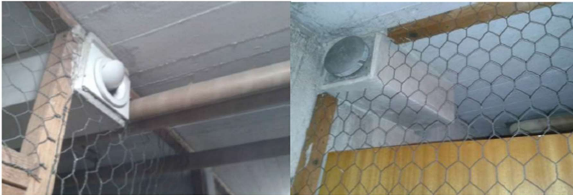
Bild på eternitkanaler i källarutrymmen med frånluftsventil samt original självdragsventil
