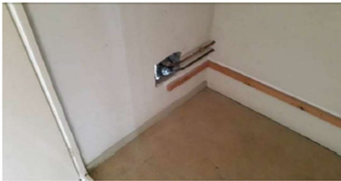
Bild på anslutning baksida av befintligt schakt för toalett i typlägenhet. Bilden är tagen inuti klädkammare.
