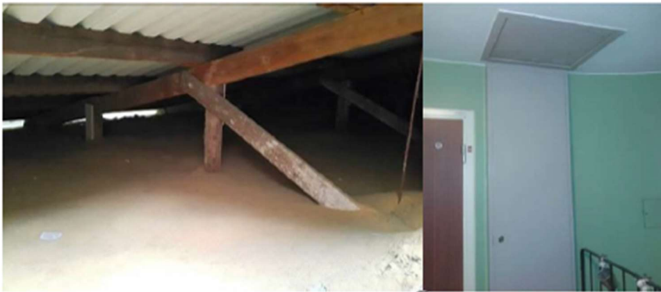
Bild på isolering av utrymme på vind samt servicelucka upp till åtkomst av vinden.
