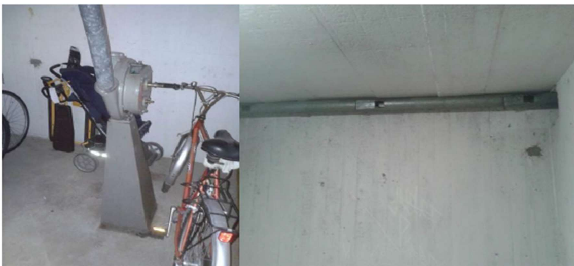
Bild på handvev och kanaler för befintlig skyddsrumsventilation.
