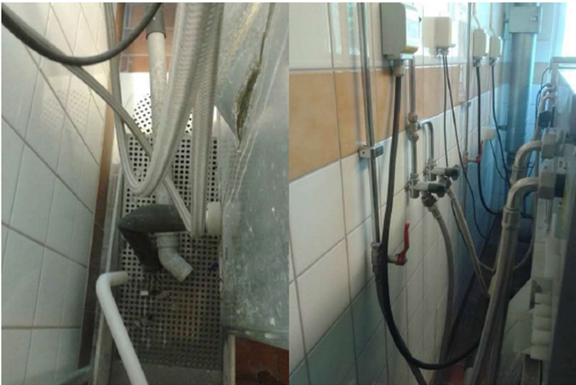
Bild på luddlåda samt på rördragningar & tappventiler till tvättmaskiner i tvättstuga.
