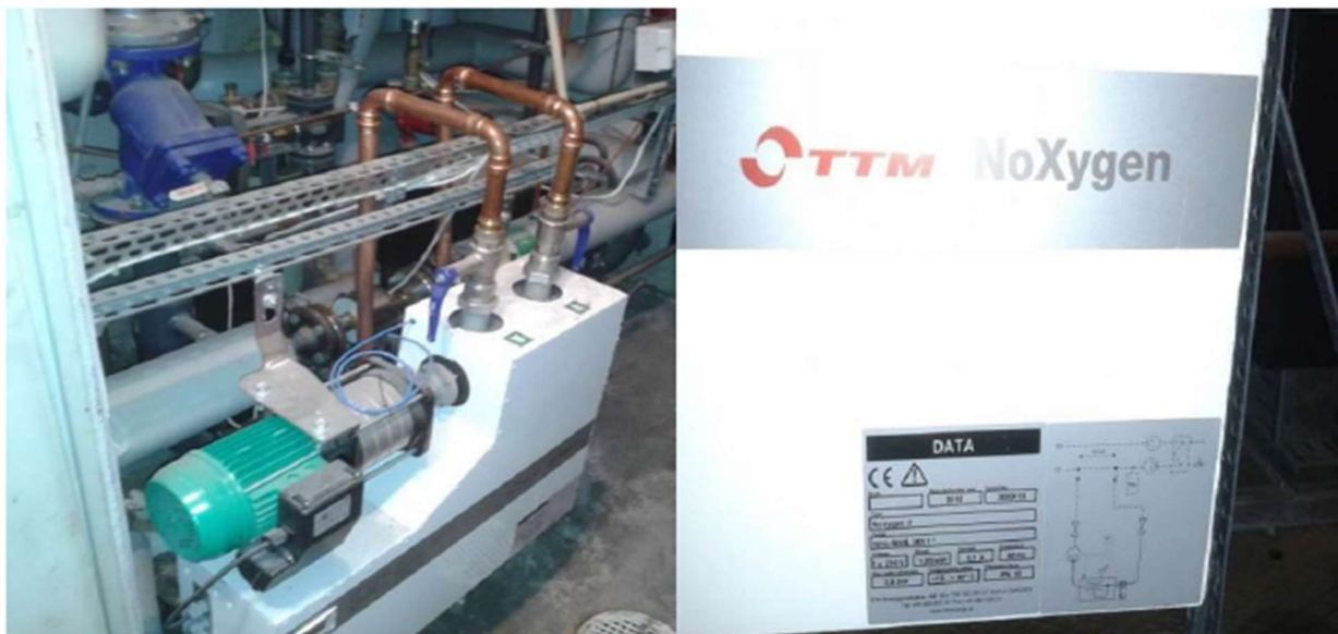
Bild på undercentral i hus 14 som är kompletterad med stationär avgasare för värmesystemet.
