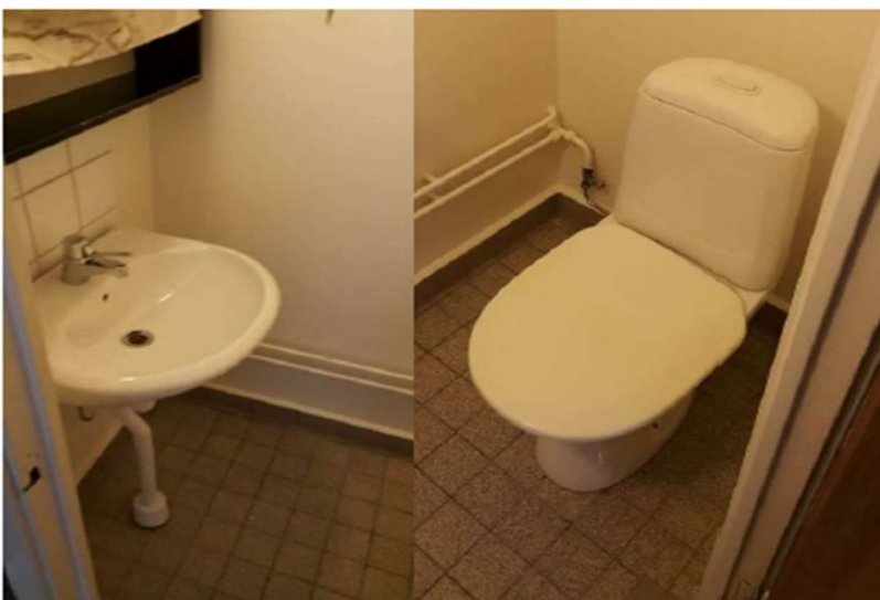
Bild på befintlig sanitetsutrustning i toalett för typlägenhet.
