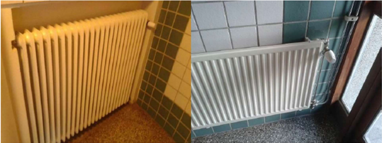
Bild på originalradiator med ny termostat samt ny radiator i trapphus.
