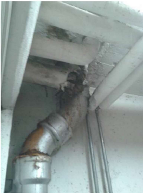
Bild på skadad isolering för tappvattenrör i källarutrymme.
