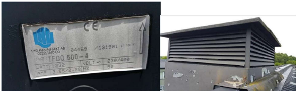
Bild på tekniska data för befintlig frånluftsfläkt och befintliga ventilationshuvar på tak.
