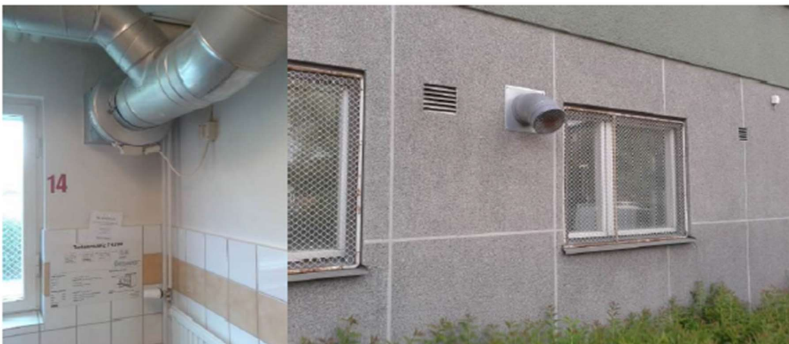
Bild på separat frånluftsfläkt för tvättstuga samt utblåskanal på fasadvägg.
