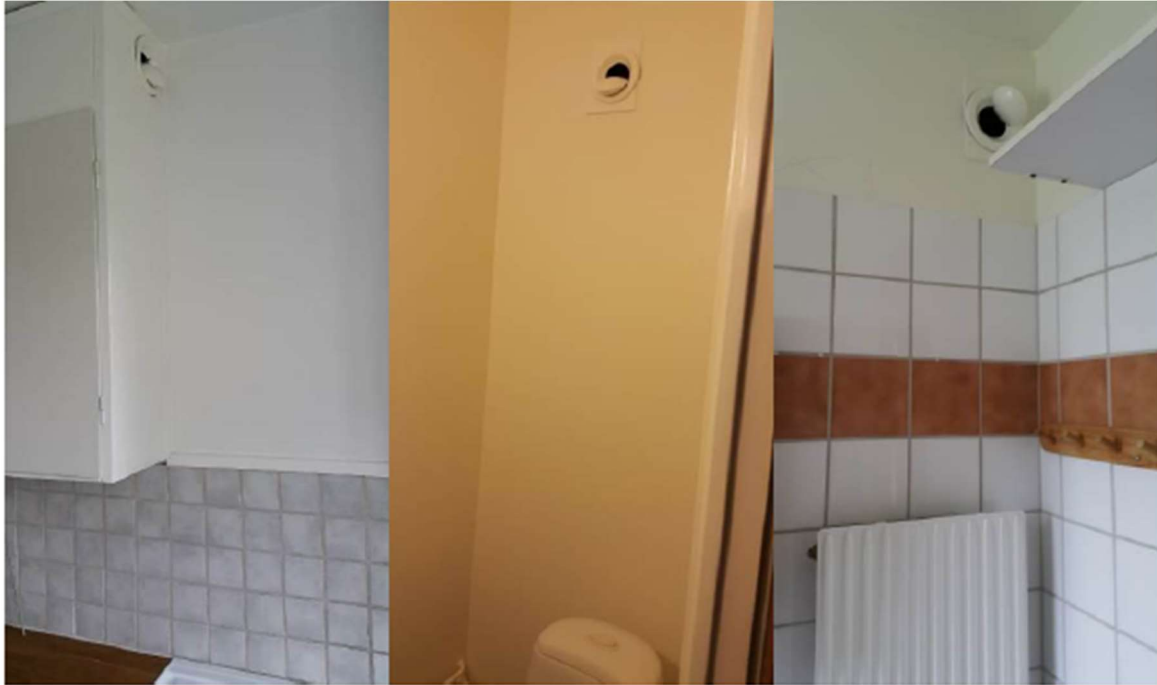
Bild på befintlig friskluftsventil i kök, toalett och badrum.
