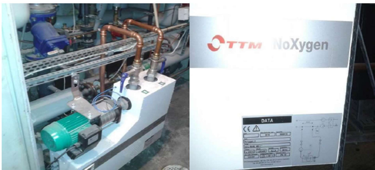
Bild på undercentral i hus 14 som är kompletterad med stationär avgasare för värmesystemet.
