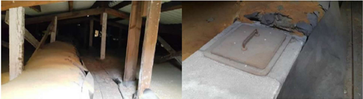
Bild på befintliga gjutna samlingskanaler med tillhörande rensluckor på vind.
