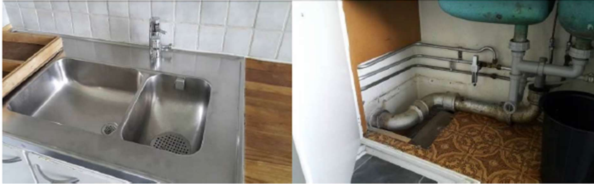
Bild på befintlig sanitetsutrustning, anslutning schaktledning och befintlig varmvattenmätare i kök för typlägenhet.
