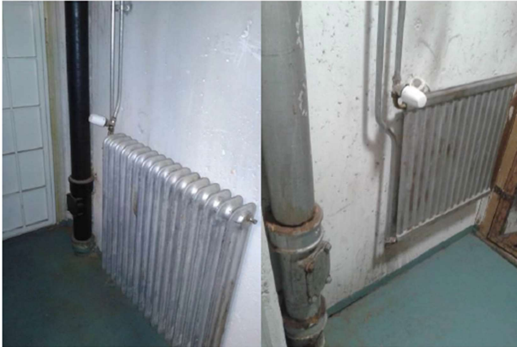
Bild på originalradiator och äldre utbytt radiator med nya termostater i källarutrymme.
