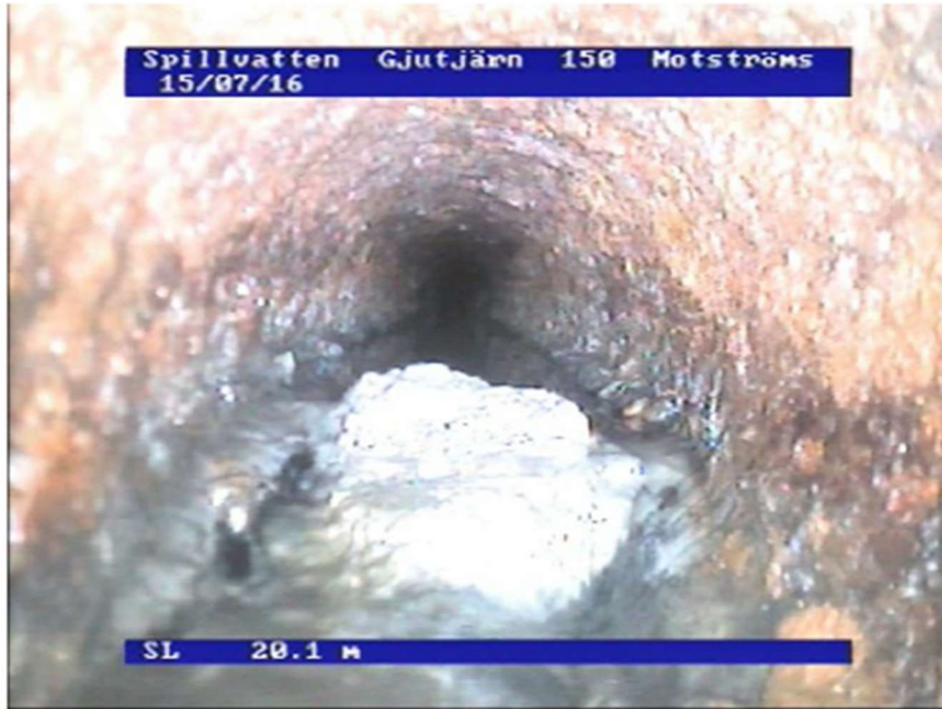
Bild på liggande S160 samlingsledning i gjutjärn under platta hus 16.
