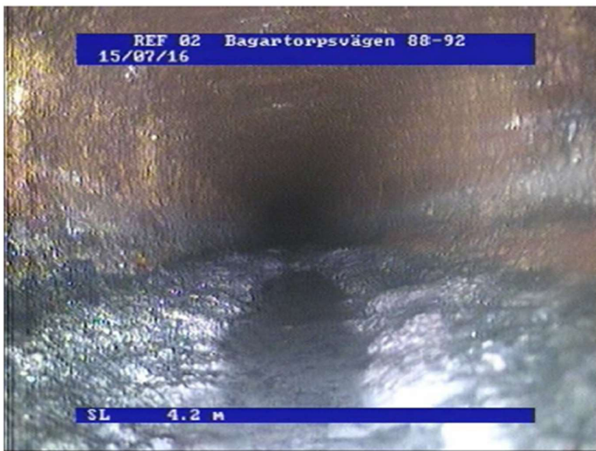
Bild på liggande S110 samlingsledning i gjutjärn under platta hus 14.
