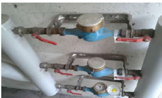
Bilder på gemensamt sopsug- och vattenmätarrum. Bilder visar inkommande servis för tappkallvatten och tillhörande vattenmätare.
