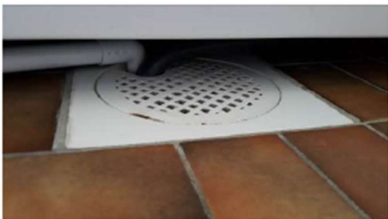
Bild på befintlig golvbrunn i badrum för typlägenhet.
