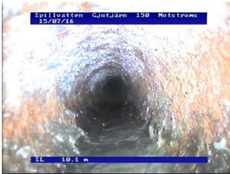
Bild på liggande S160 samlingsledning i gjutjärn under platta hus 15 som försörjer garageutrymmen. Bilden visar utfällningar och ledning i dåligt skick.
