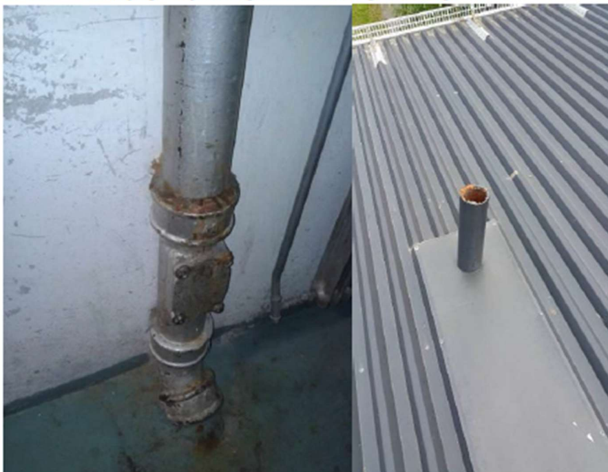
Bild på spillvattenstam i originalskick med renslucka samt bild på luftning för spillvattenstam. Observera kraftig korrosion på insida av ledning.
