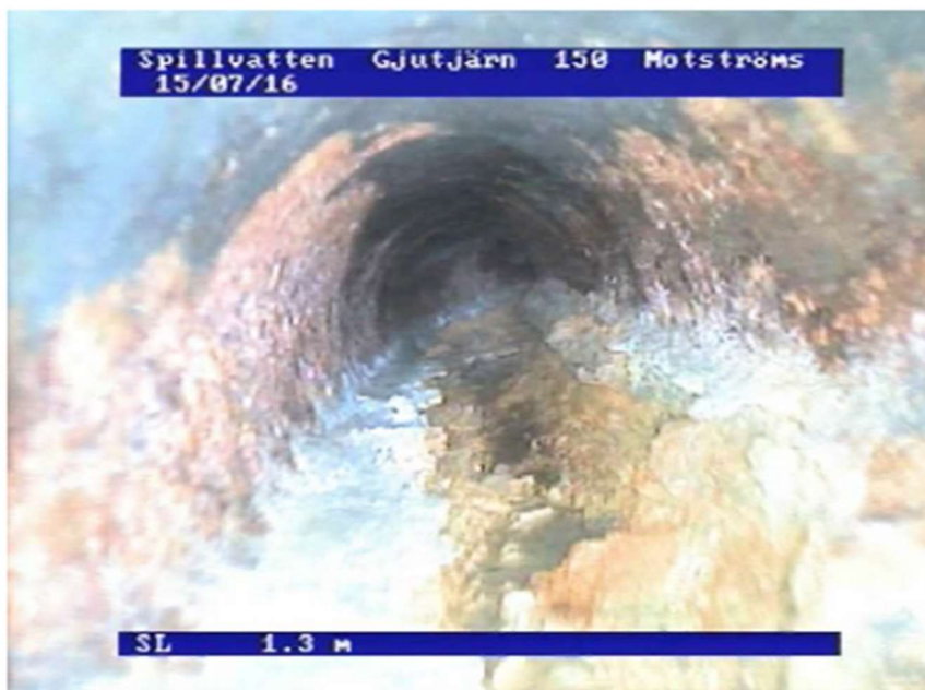
Bild på liggande S160 samlingsledning i gjutjärn under platta hus 14 som försörjer garageutrymmen. Bilden visar mycket kraftig ansamling av utfällningar och ledning i mycket dåligt skick.
