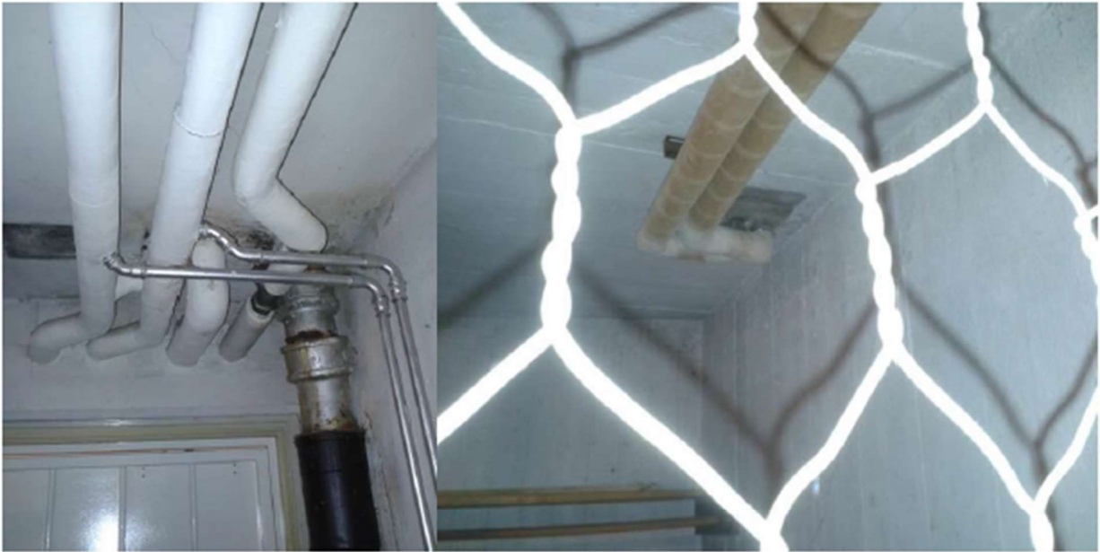
Bild på värmerör i källare med originalisolering och oisolerade avstick till radiator.
