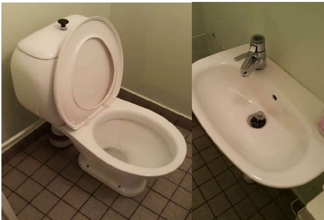
Bild på sanitetsenheter för WC i möteslokal. Bilden visar slitet skick och ålder på sanitetsenheter.
