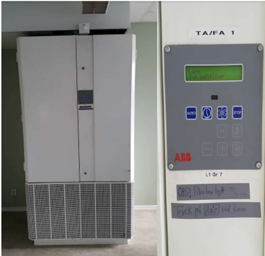
Bild på till- och frånluftsaggregat i möteslokal.
