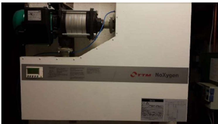
Bild kompletterad avgasare i undercentral.
