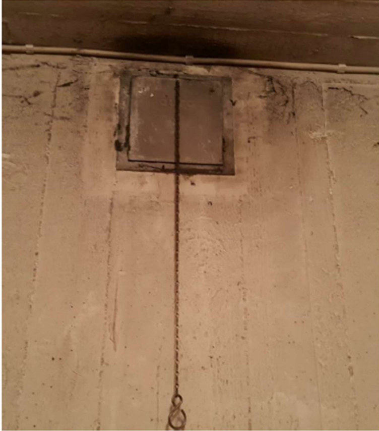
Bild på friskluftsintag i källarförråd. Bilden visar friskluftsventil från 1960-tal.
