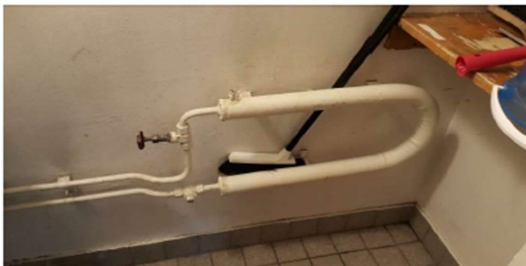
Bild på handduktork i städutrymme. Bilden visar handduktork från 1960-tal som är kopplad på VVC-ledning.
