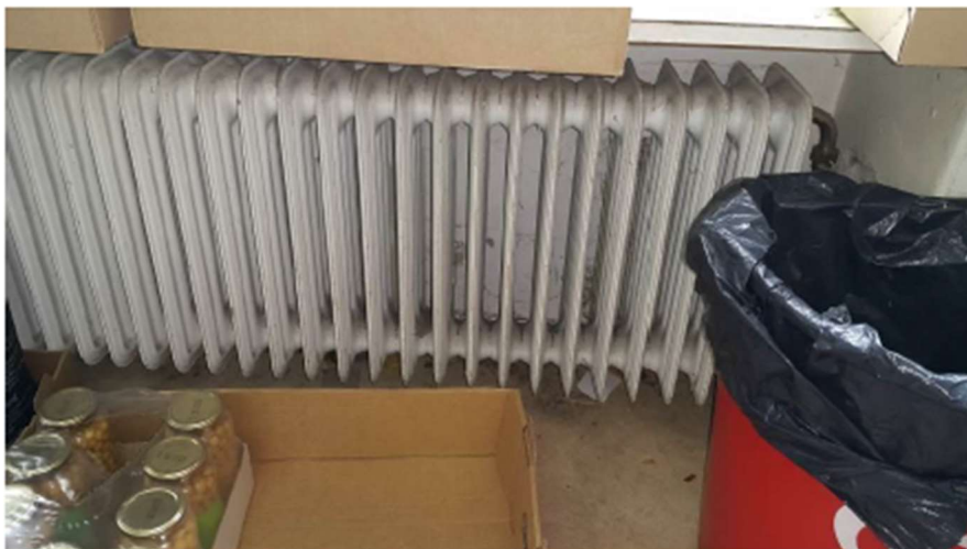
Bild på radiator i butikslokal. Bilden visar originalradiator från 1960-talet.
