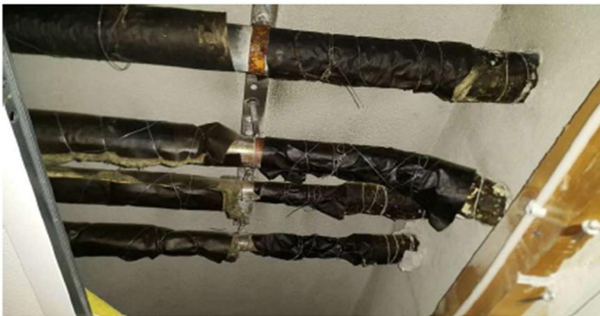
Bild på rörstråk ovan undertak i källarkorridor. Bilden visar undermåligt isolerade rörledningar.
