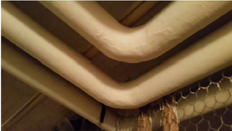
Bild på befintlig isolering i källarförråd. Bilden visar rörböjar med asbestisolering.
