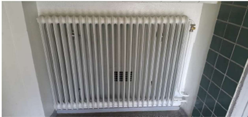
Bild på radiator i trapphus. Bilden visar friskluftsintag bakom radiator.
