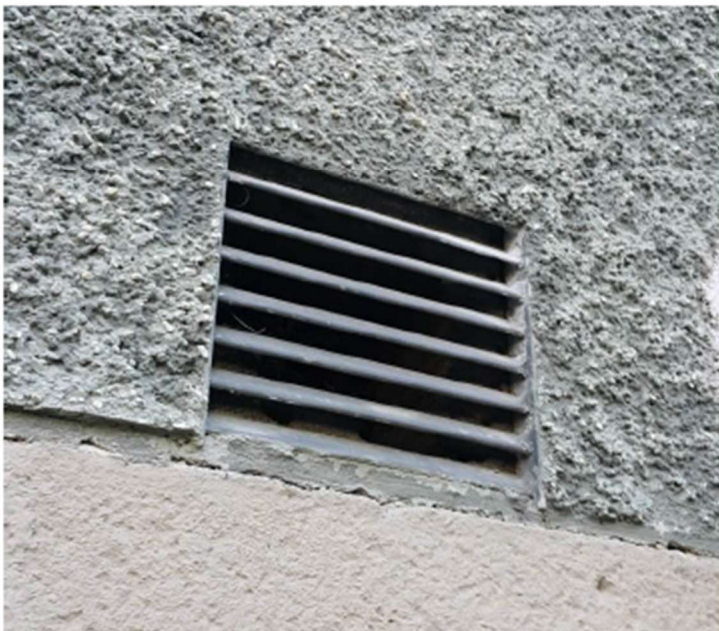
Bild på friskluftsintag i fasad.
