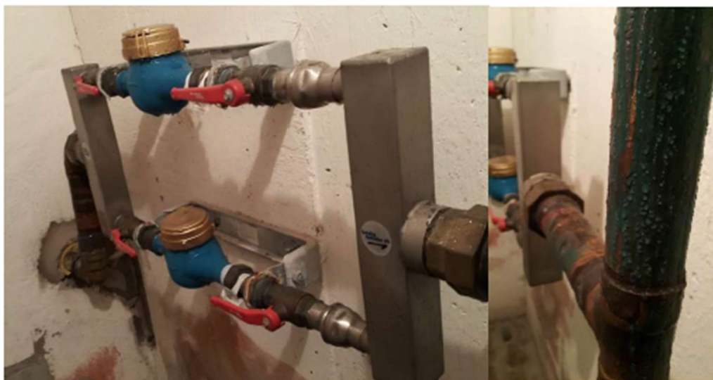
Bild på vattenmätare i hus 3. Bilden visar undermåligt isolerade rörledningar med kraftig kondensutfällning på yta.
