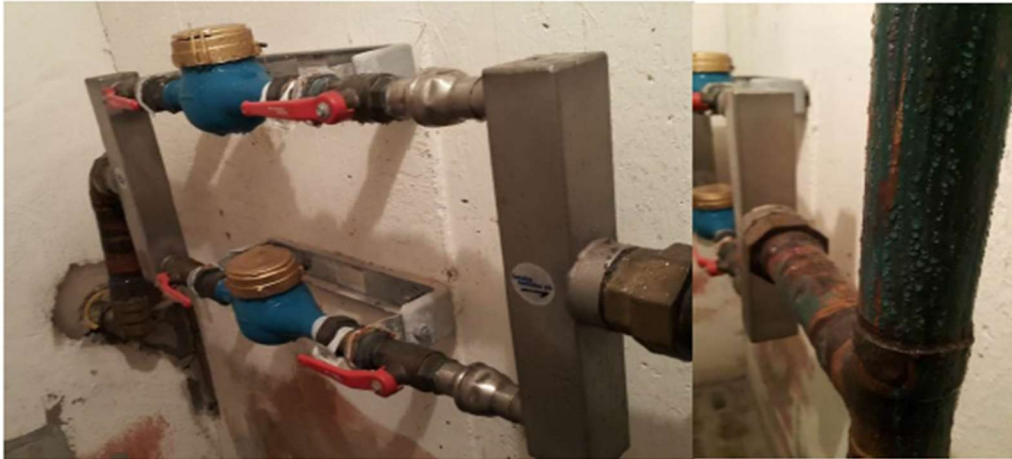
Bild på vattenmätare i hus 3.
