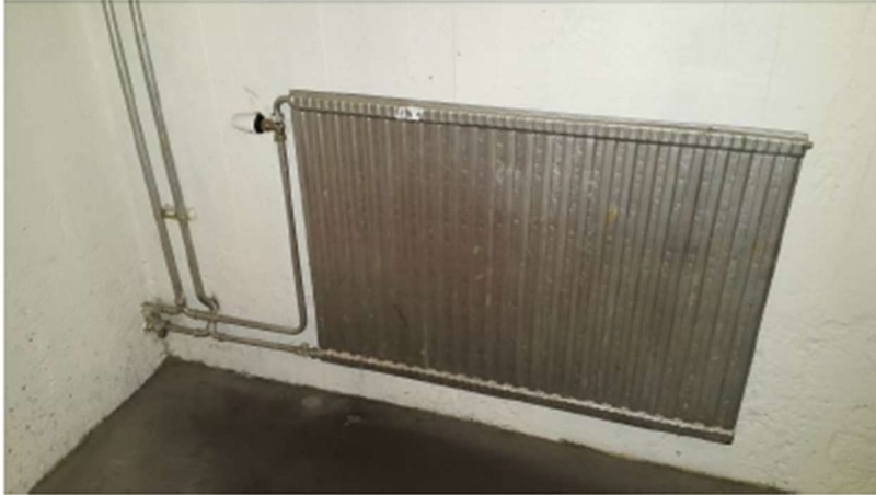
Bild på radiator i skyddsrum.
