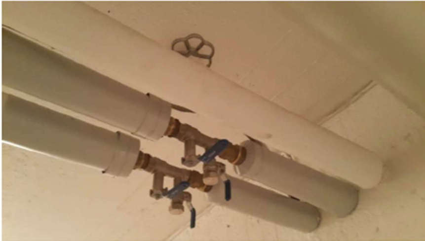
Bild på rörstråk i källarkorridor. Bilden visar nyare reparerad isolering samt originalisolering. Observera utbytta ventiler samt originalventil på VVC-ledning.
