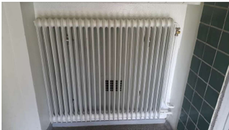
Bild på radiator i trapphus. Bilden visar friskluftsintag bakom radiator.
