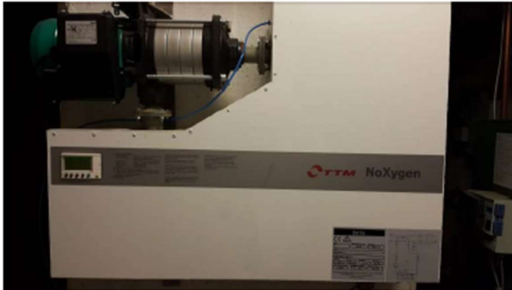
Bild kompletterad avgasare i undercentral.
