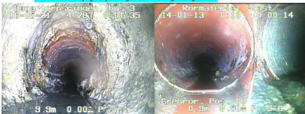
Bild på liggande S160 samlingsledning i gjutjärn under platta för hus 3. Vänstra bilden visar mycket kraftiga utfällningar och ledning i dåligt skick. Högra bilden visar anslutande plastledning utanför huskropp. Till höger på bilden syns anslutande rör av annat material.
