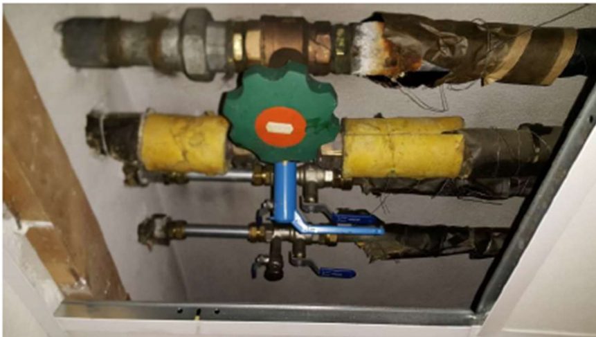
Bild på rörventiler ovan undertak i källarkorridor. Bilden visar undermåligt isolerade ventiler samt ventiler i mycket blandat skick.
