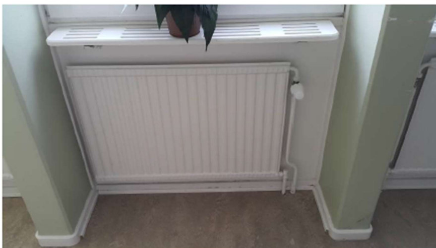
Bild på radiator i möteslokal. Bilden visar nyare målad radiator.
