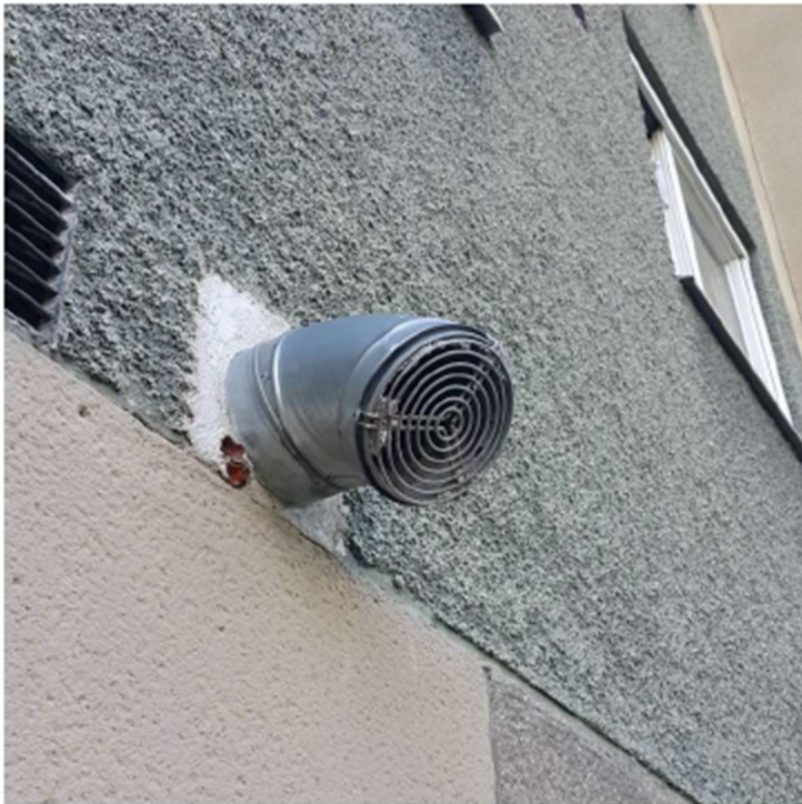
Bild ventilationsutblås från tvättstuga.
