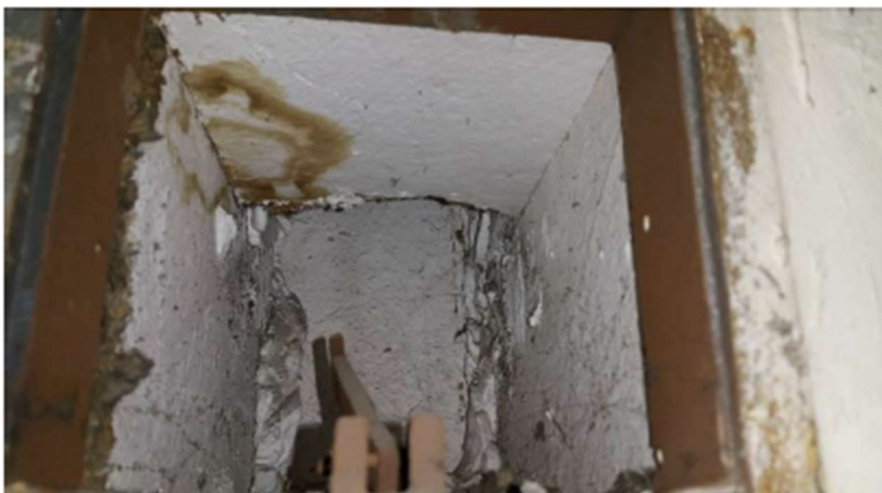
Bild på eternitkanal i källarförråd. Bilden visar skick inuti kanal.
