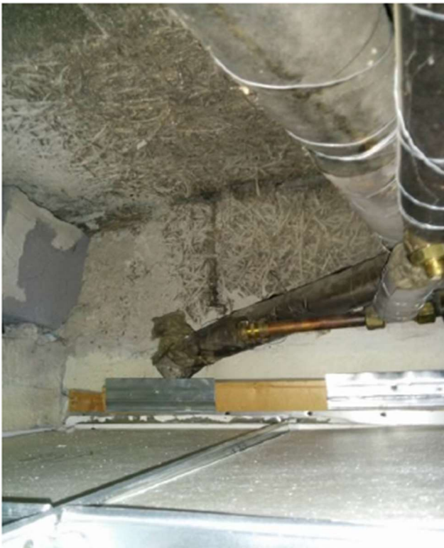
Bild på tappvattenrörstråk ovan undertak i källare.
