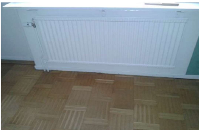
Befintlig utbytt panelradiator i vardagsrum.
