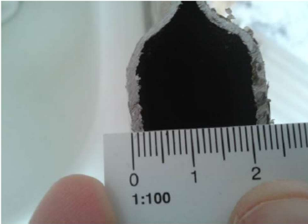
Bild på mätning av kvarvarande godstjocklek för befintlig Observera tunn kvarvarande tjocklek på gods i övre vän:
