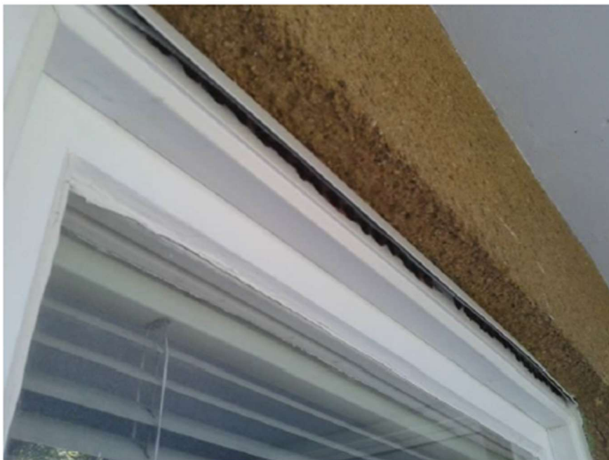
Utsida fönster med synliga kompletterande hål för friskluft efter radonmätningar.
