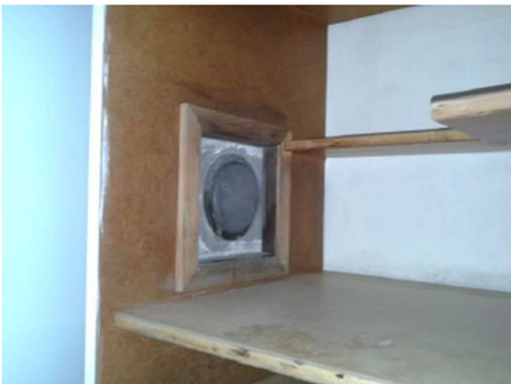
Befintlig friskluftsventil i köksskaffereri.
