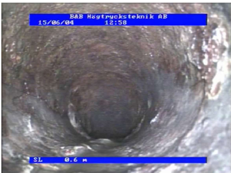
Bild på stående S100 spillvattenstam i gjutjärn. Bilden visar sprickbildningar i rörvägg troligtvis pga. tunn kvarvarande godstjocklek.
