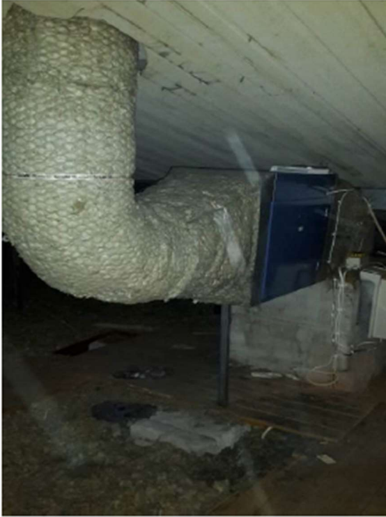
Bild på befintliga frånluftsfläktar på kallvind.
