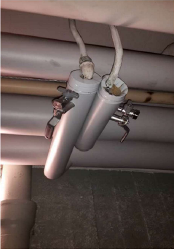
Bild på befintligt avstick värmerör där injusteringsventil saknas.
