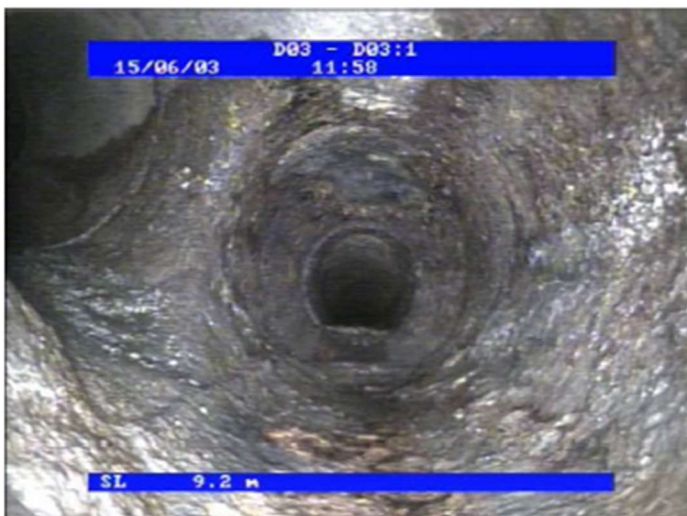
Bild på liggande D150 samlingsledning i gjutjärn under platts med anslutande grenledning. Bilden visar mycket kraftiga utfällningar och ledning i mycket dåligt skick.
