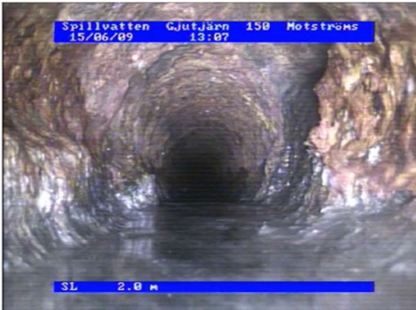
Bild på liggande S150 samlingsledning i gjutjärn under platta. Bilden visar mycket kraftiga utfällningar och ledning i mycket dåligt skick.
