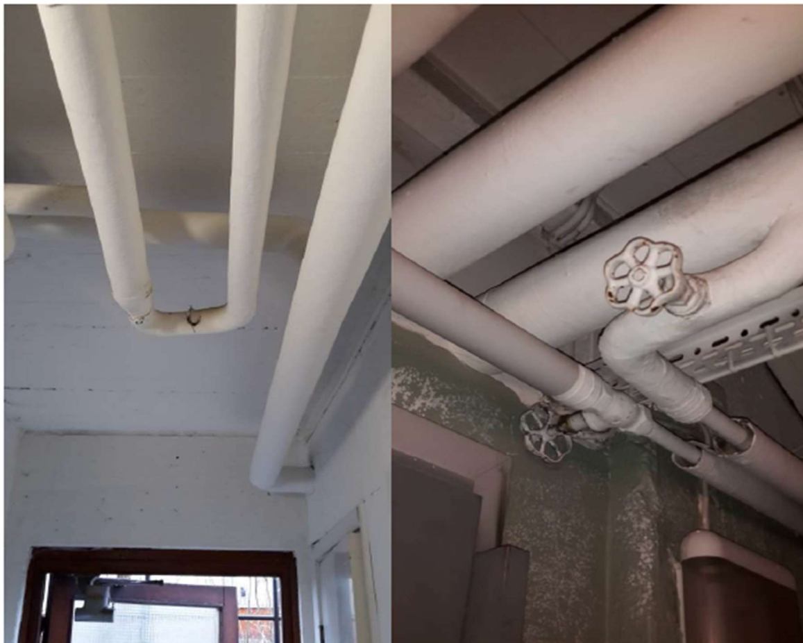
Bild på VVC ihopkopplat med varmvatten i källarstråk respektive befintliga avstängningsventiler.
