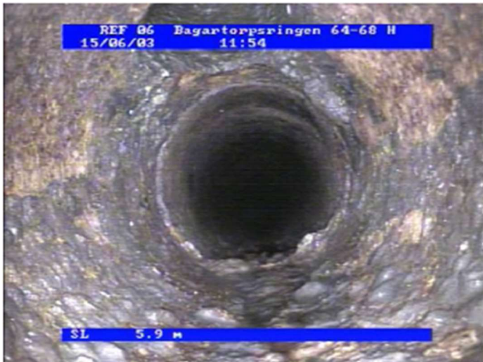
Bild på liggande D150 samlingsledning i gjutjärn under platta. Bilden visar mycket kraftiga utfällningar och ledning i mycket dåligt skick.
