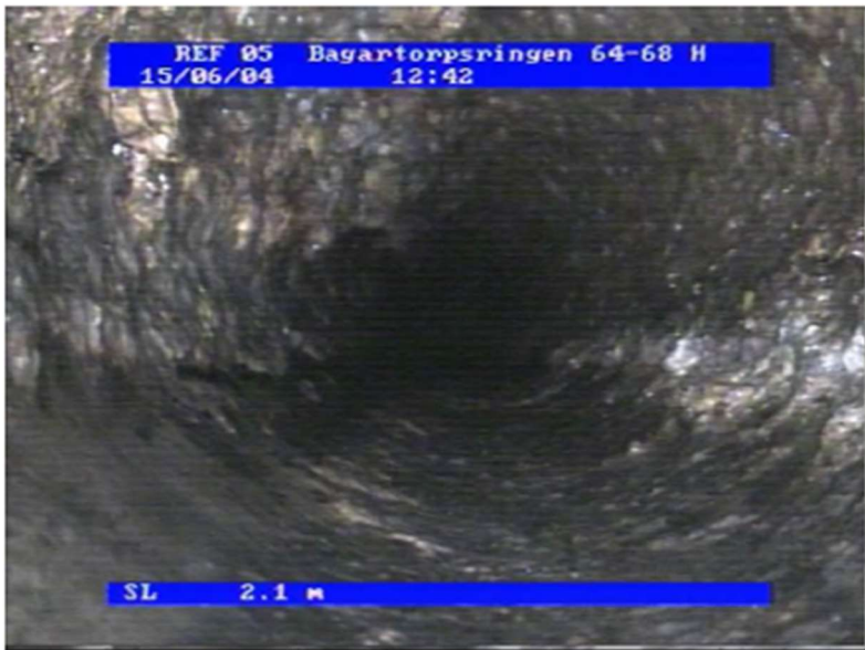
Bild på stående S75 spillvattenstam i gjutjärn.
