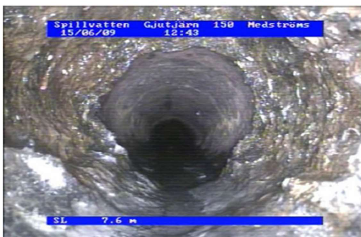
Bild på liggande S150 samlingsledning i gjutjärn under platta.
