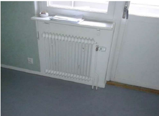
Befintlig originalradiator i sovrum.
