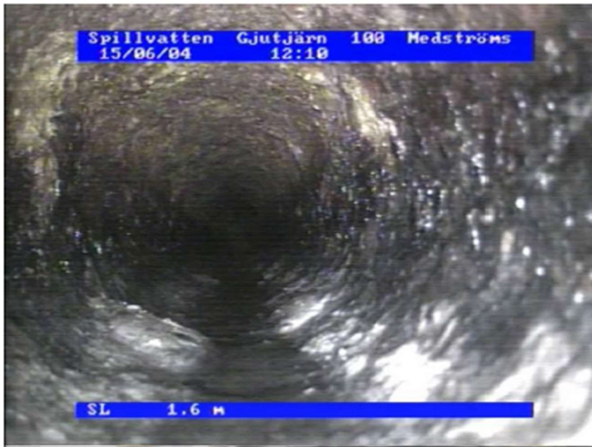
Bild på stående S100 spillvattenstam i gjutjärn.
