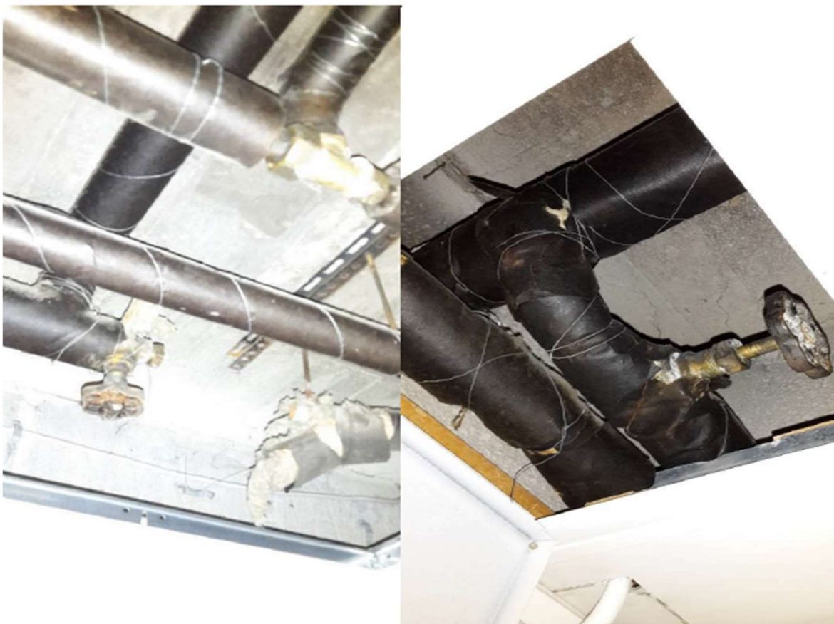
Bild på trasiga rör i källarstråk respektive befintliga rör och ventiler i källarstråk.
