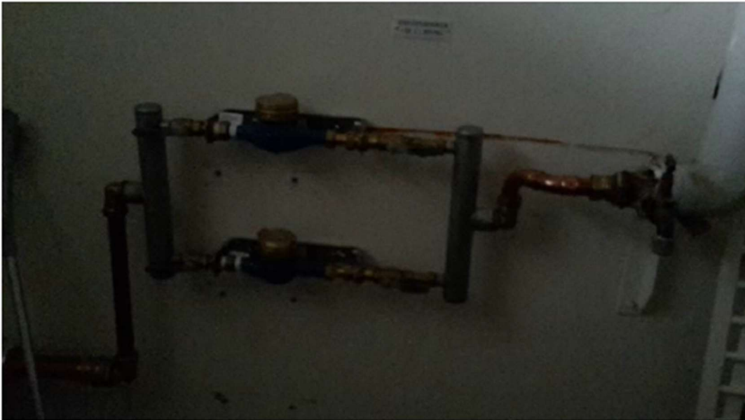
Bild på befintlig vattenmätare för inkommande kallvattenservis
