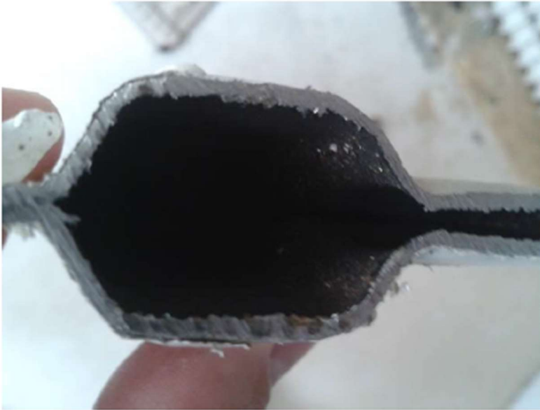
Bild på befintlig nyare radiator i vardagsrum. Bild visar kvarvarande godstjocklek.
